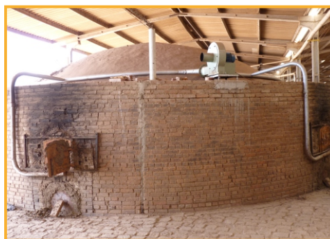
Insuflamento de ar de combustão
