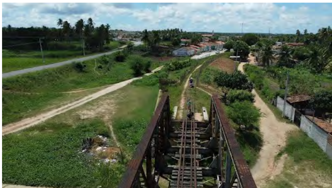
Figura 147 – Situação de segmento em Pedro Velho (RN) – 2022
