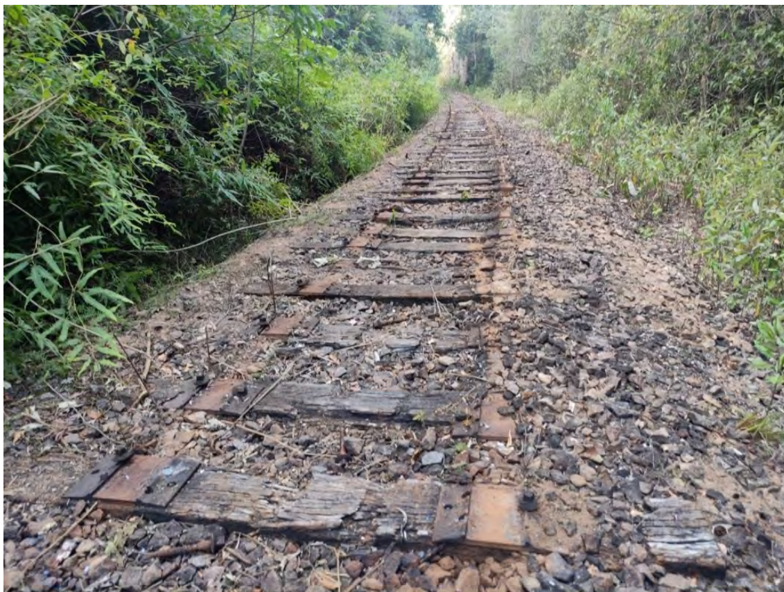
Figura 218 – Registro de furto de trilhos nas imediações de Vargem Alta (ES) – 2022
