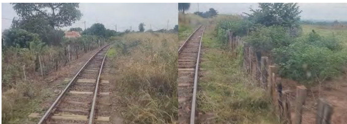
Figura 101 – Invasão da faixa de domínio do km 289,8 ao km 289,9
