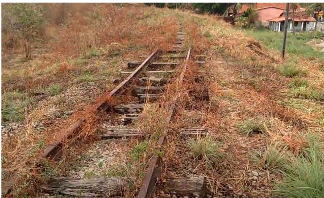
Figura 178 – Situação do segmento em Guaiúba (CE) – 2019
