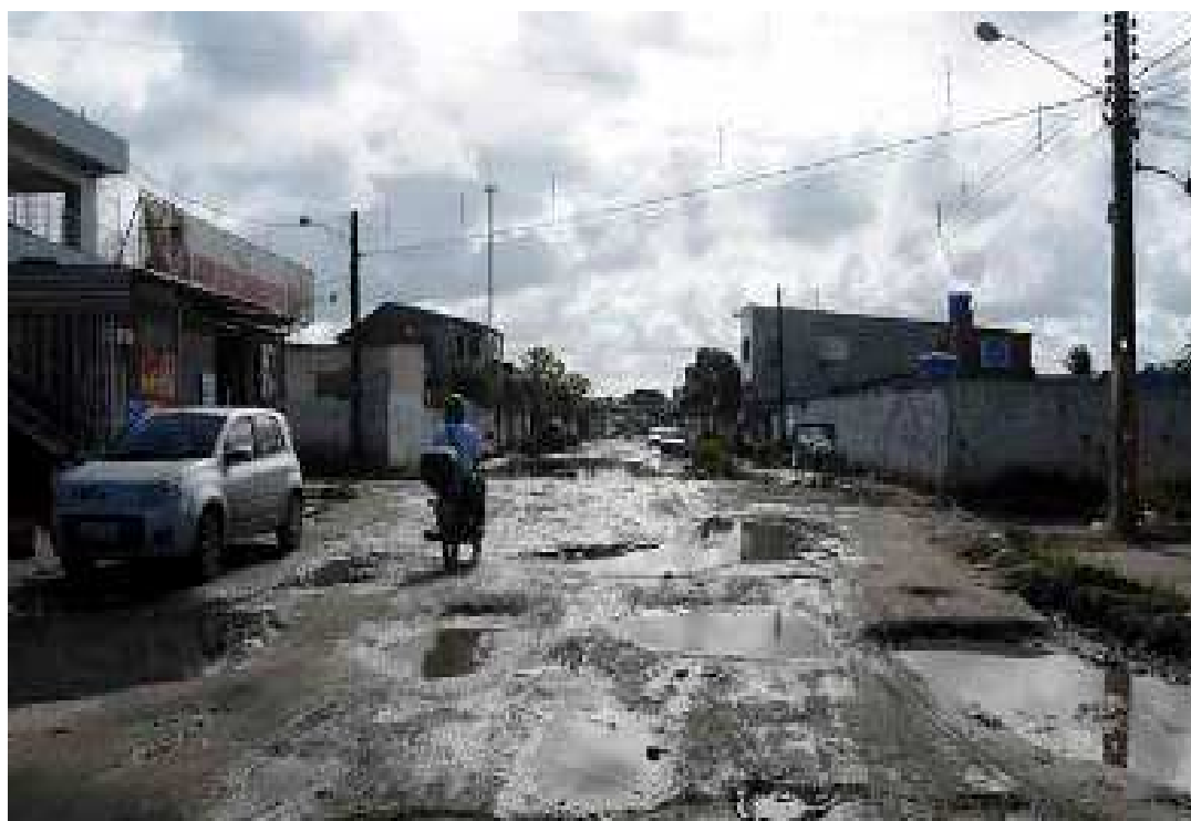
Foto 03 – Buracos nas ruas. Fonte: Arquivo pessoal do autor.
