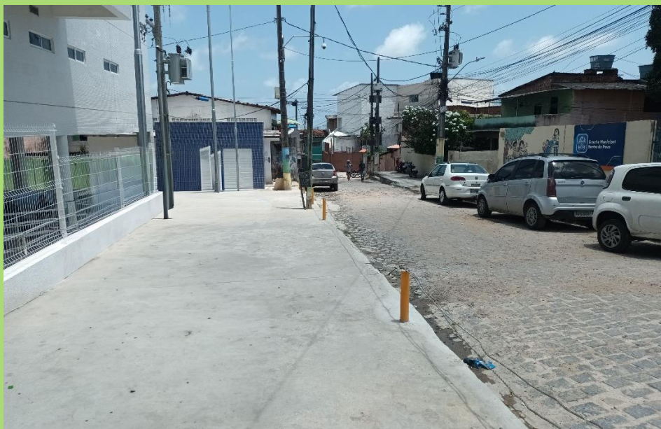
Figura 77 – Situação antes: calçada localizada no acesso a um equipamento de educação.
