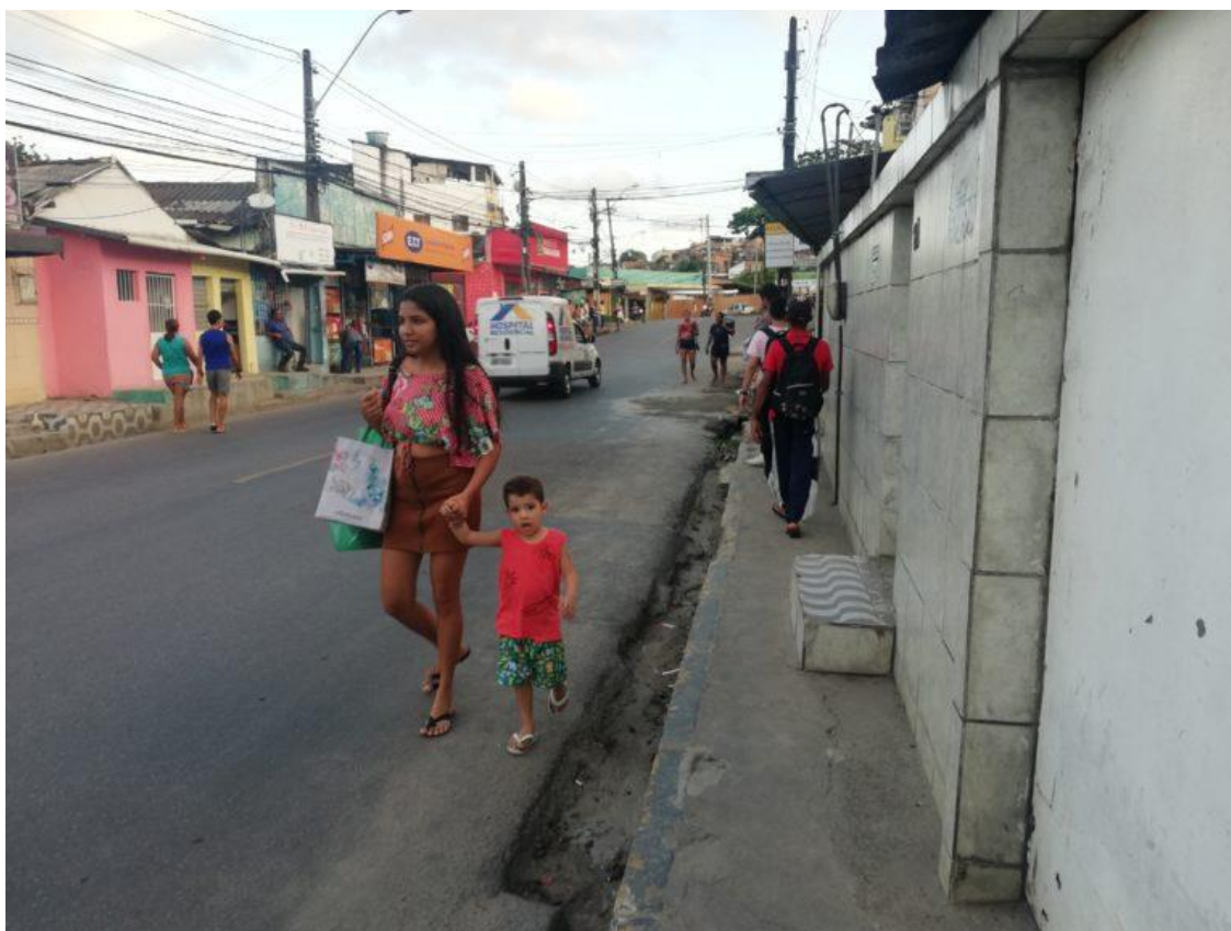
Figura 5 - Falta de infraestrutura para o transporte ativo.
