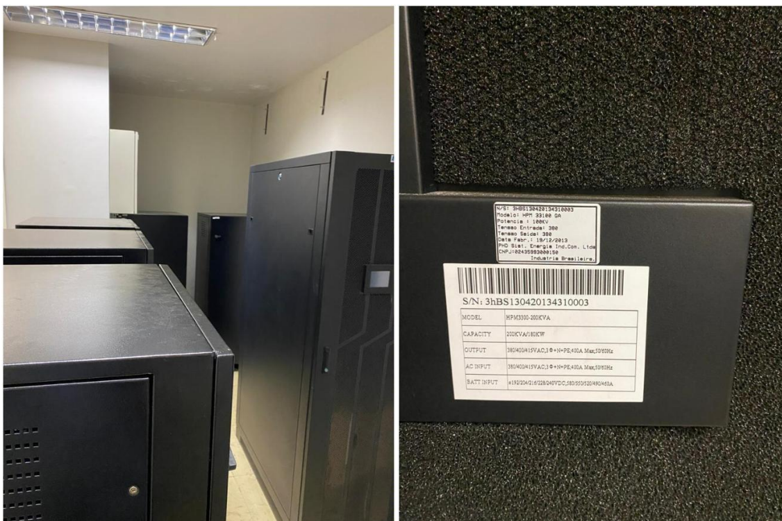
Figuras 3: UPS “no-break” Ed. Sede.
