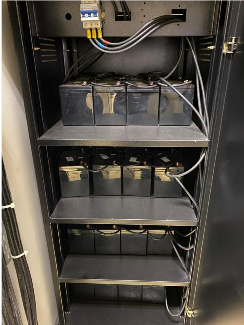
Figura 4: Banco de Baterias Ed. Sede.
