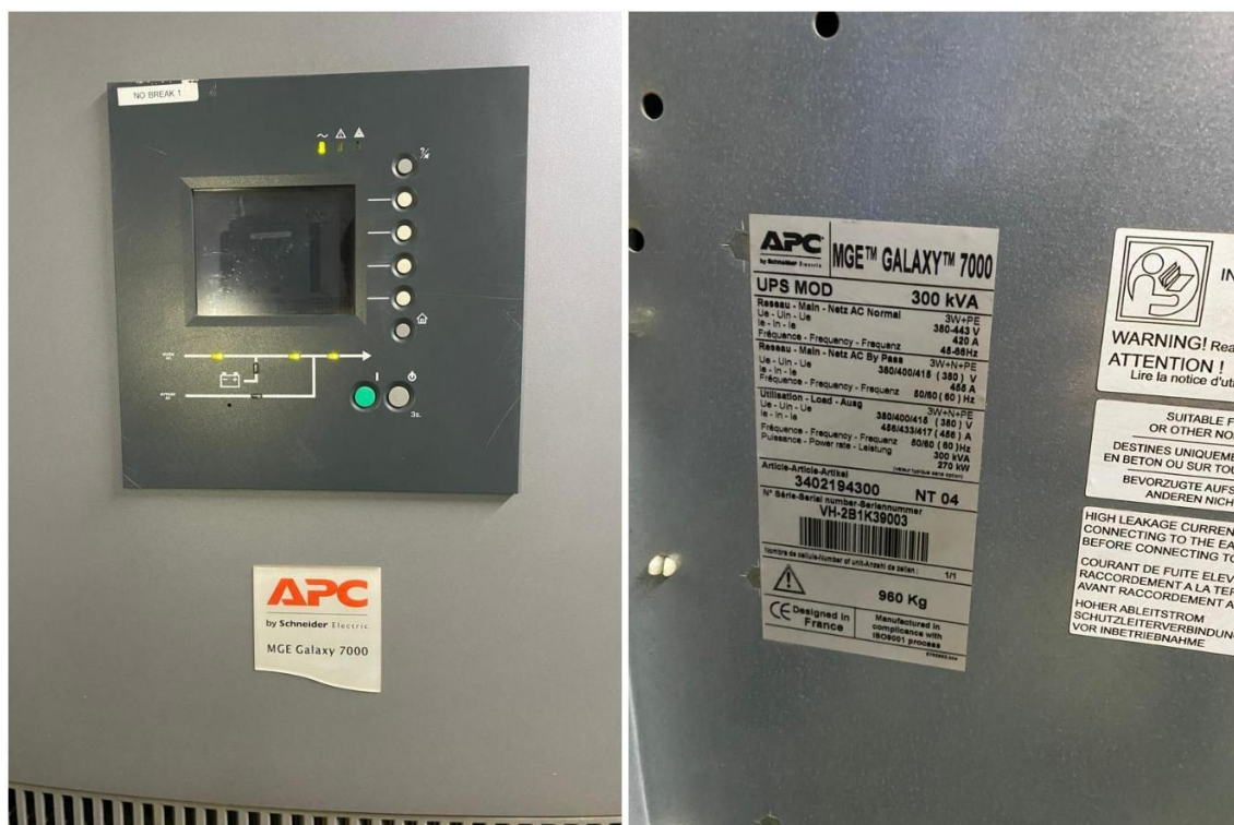
Figuras 1: UPS “no-break” Ed. Anexo.
