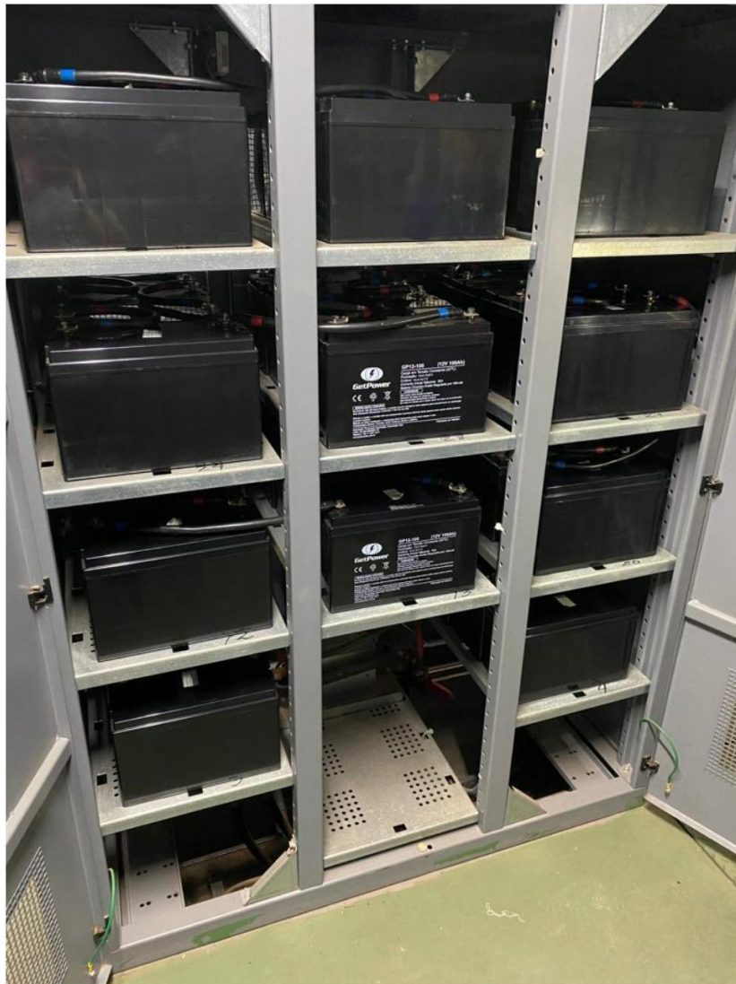
Figura 2: Banco de baterias Ed. Anexo.
