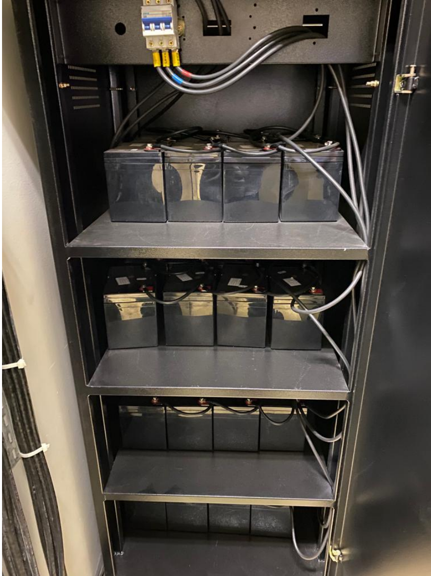
Figura 4: Banco de Baterias Ed. Sede.
