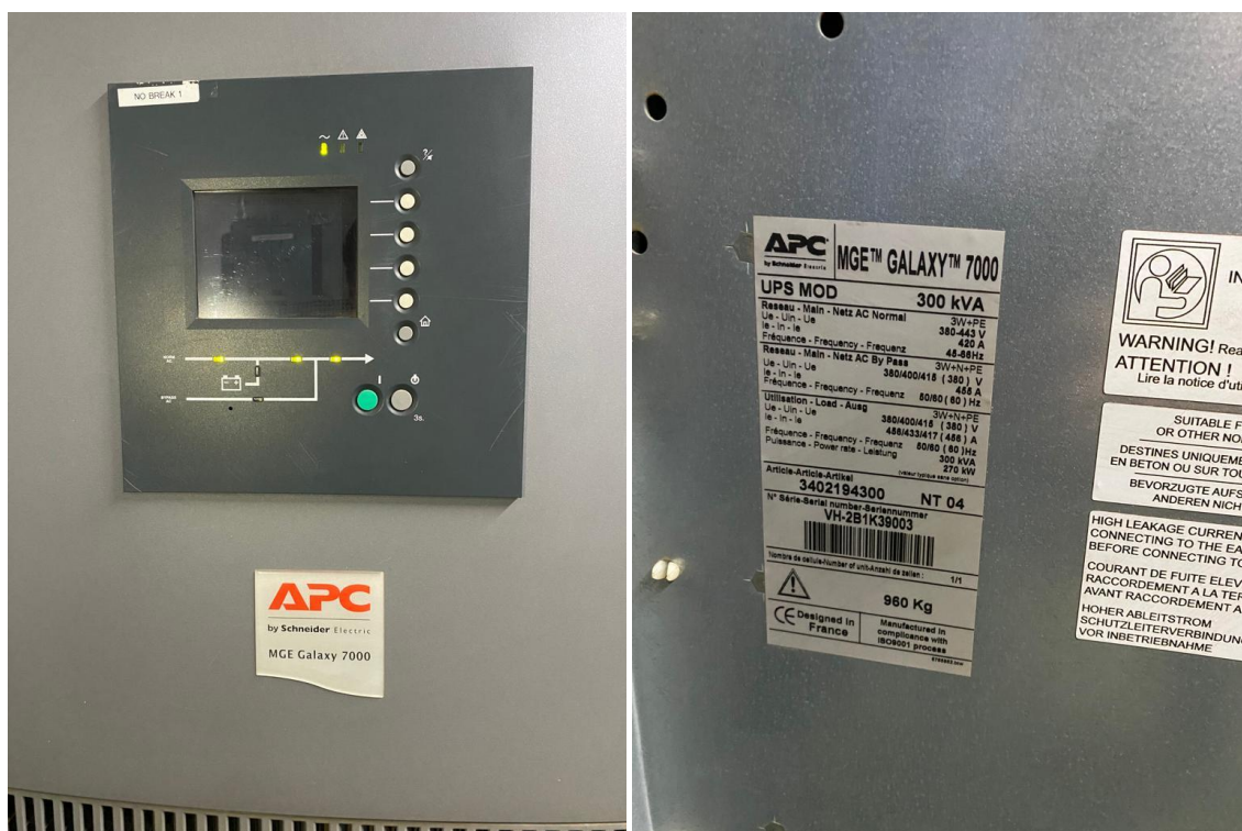
Figuras 1: UPS “no-break” Ed. Anexo.
