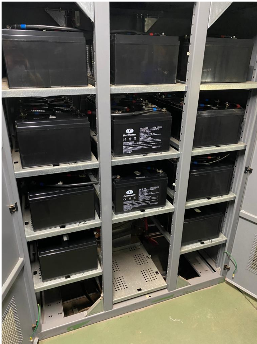
Figura 2: Banco de baterias Ed. Anexo.
