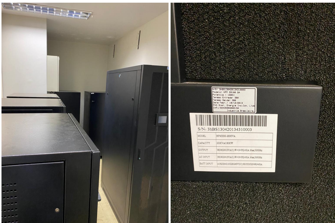
Figuras 3: UPS “no-break” Ed. Sede.
