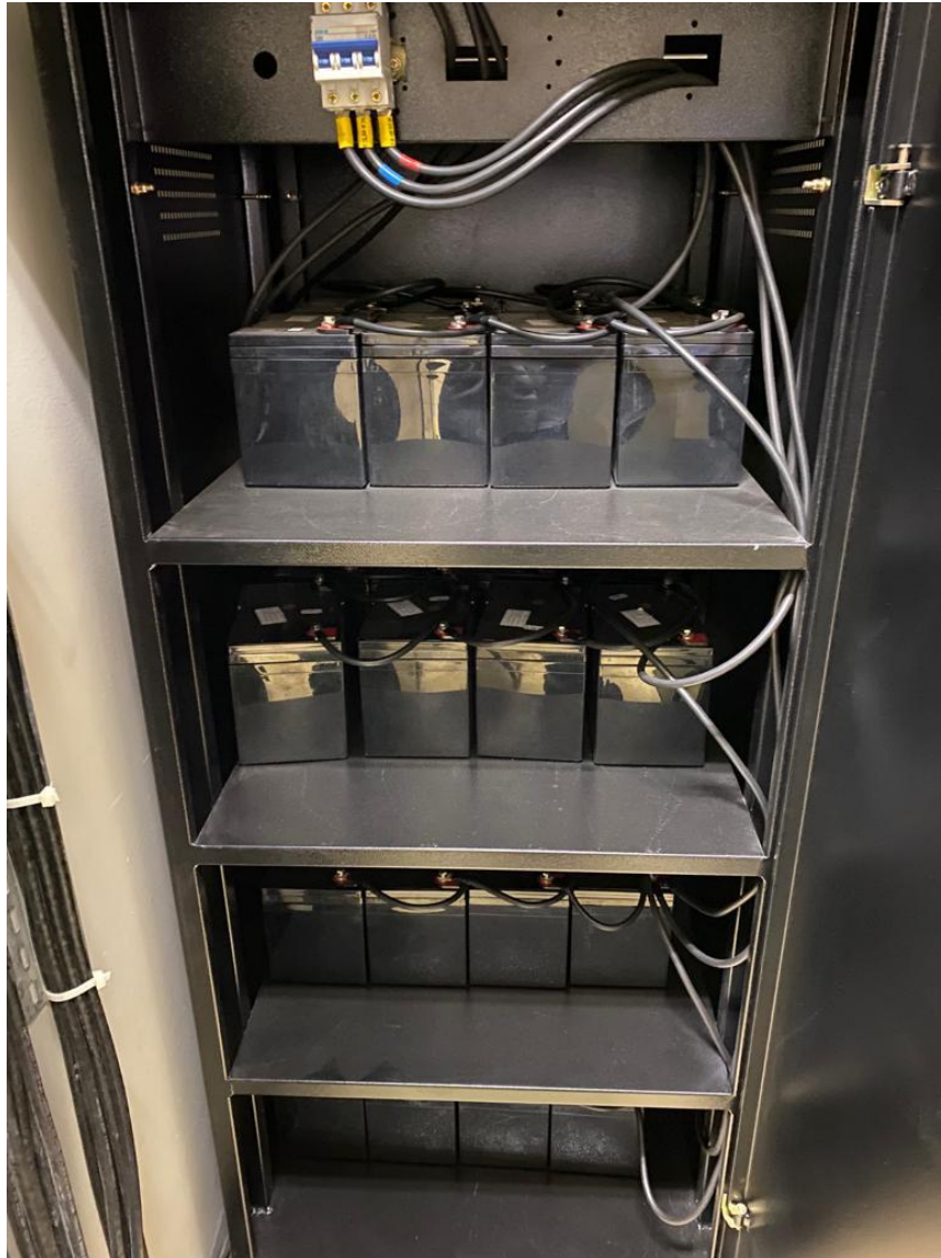
Figura 4: Banco de Baterias Ed. Sede.
