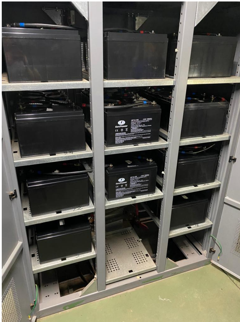
Figura 2: Banco de baterias Ed. Anexo.
