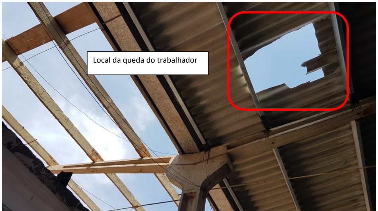
Figura 3 – Parte do telhado que quebrou ocasionando a queda do trabalhador.
