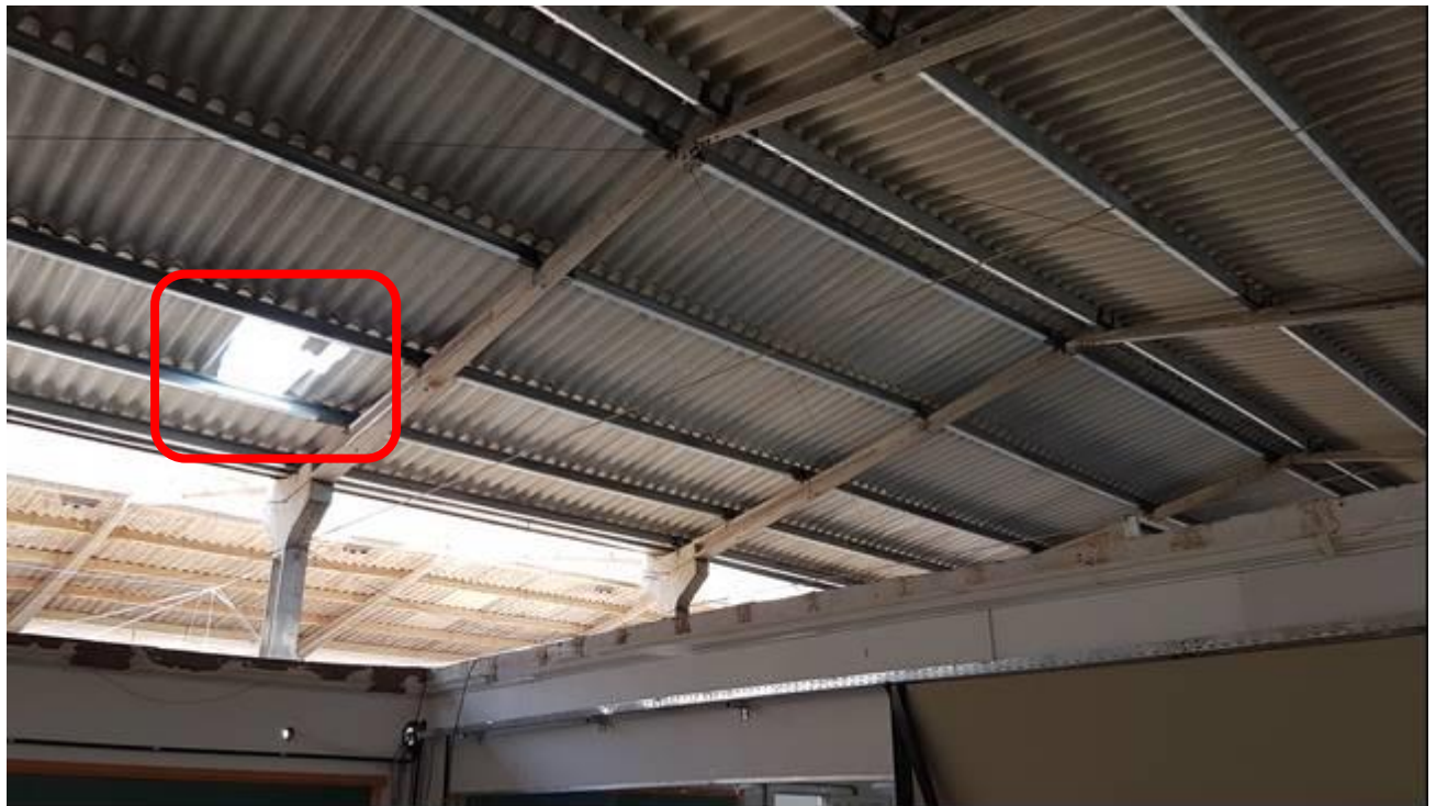
Figura 4 – Galpão onde houve a queda do trabalhador com as telhas novas.
