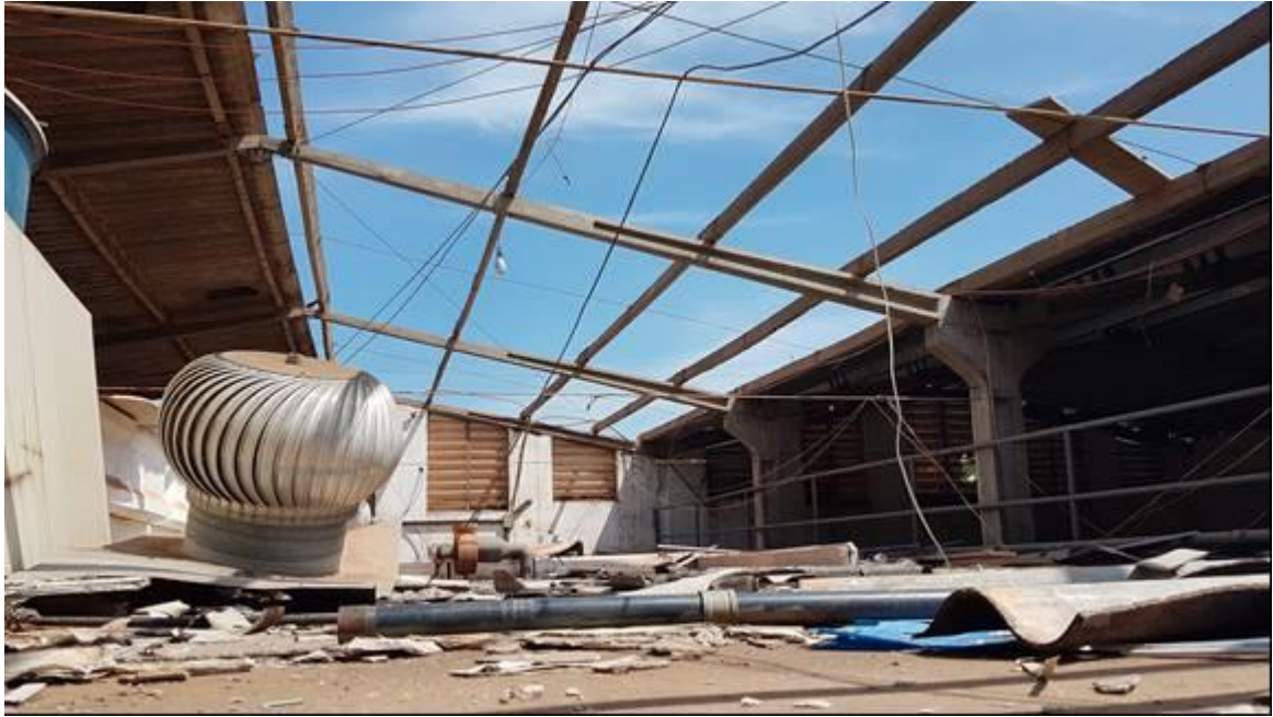
Figura 1 – Área que estava em obras para troca da telha, o trabalhador se acidentou no telhado à direita.
