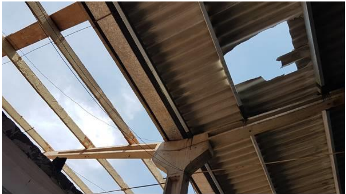
Figura 2 – Telhada quebrada pelo peso do trabalhador que culminou com a queda e morte.
