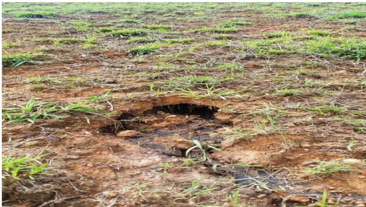
Figura 120: Erosão (ravina) no talude
