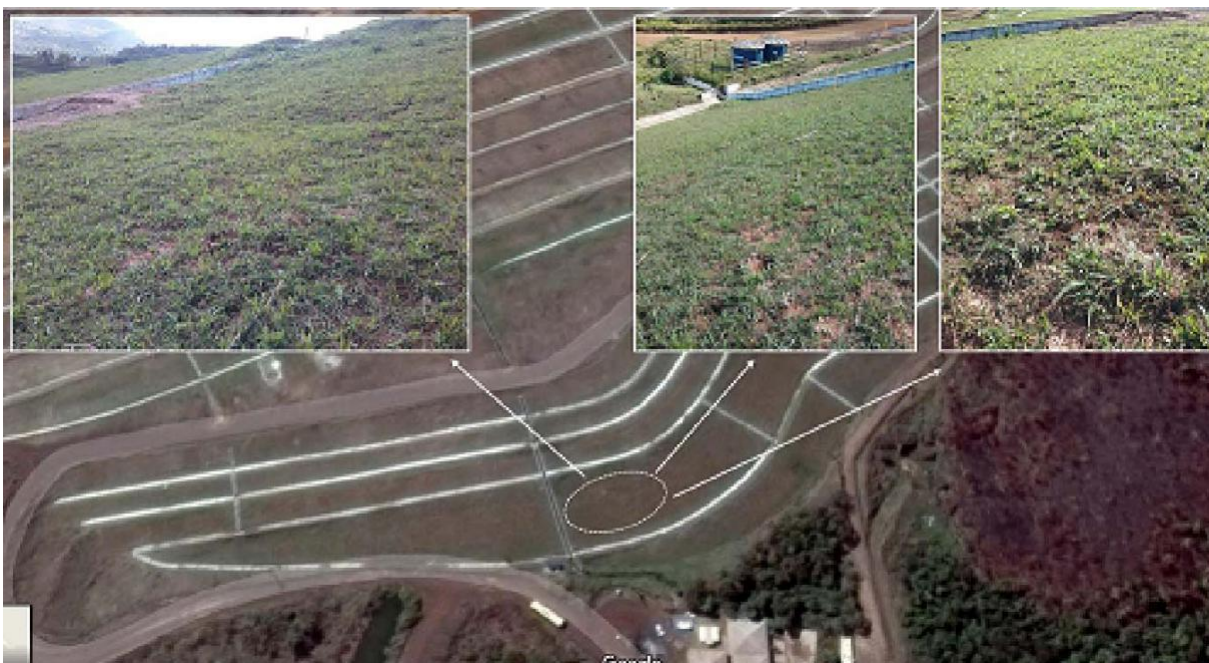
Figura 99: Surgências de água no talude principal
