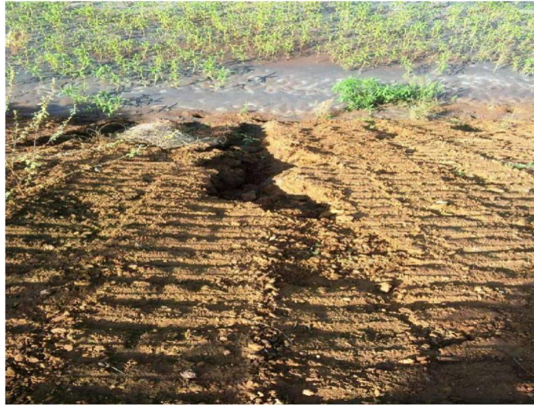
Figura 117: Erosão (ravina) no talude do barramento
