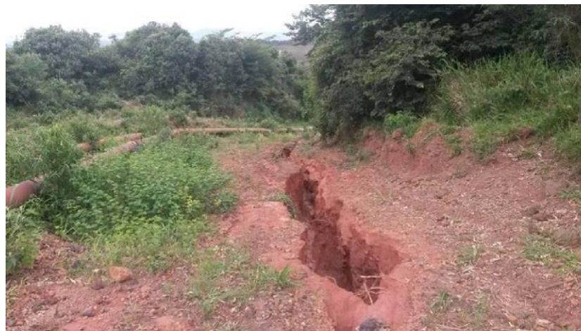
Figura 119: Erosão no acesso à barragem
