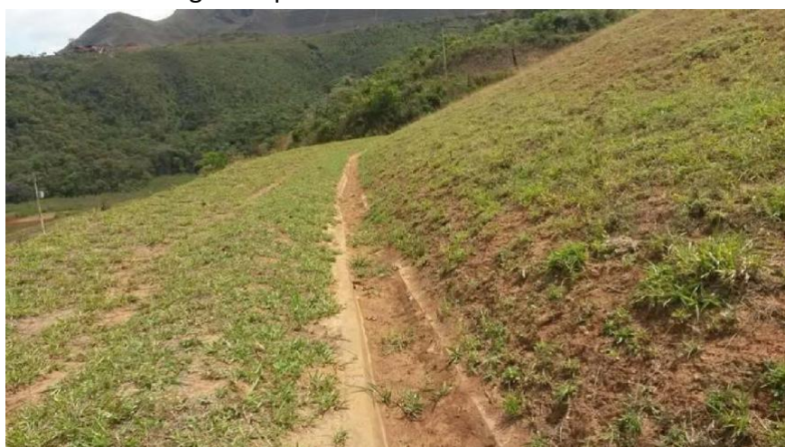
Figura 105: Canaleta de drenagem superficial assoreada
