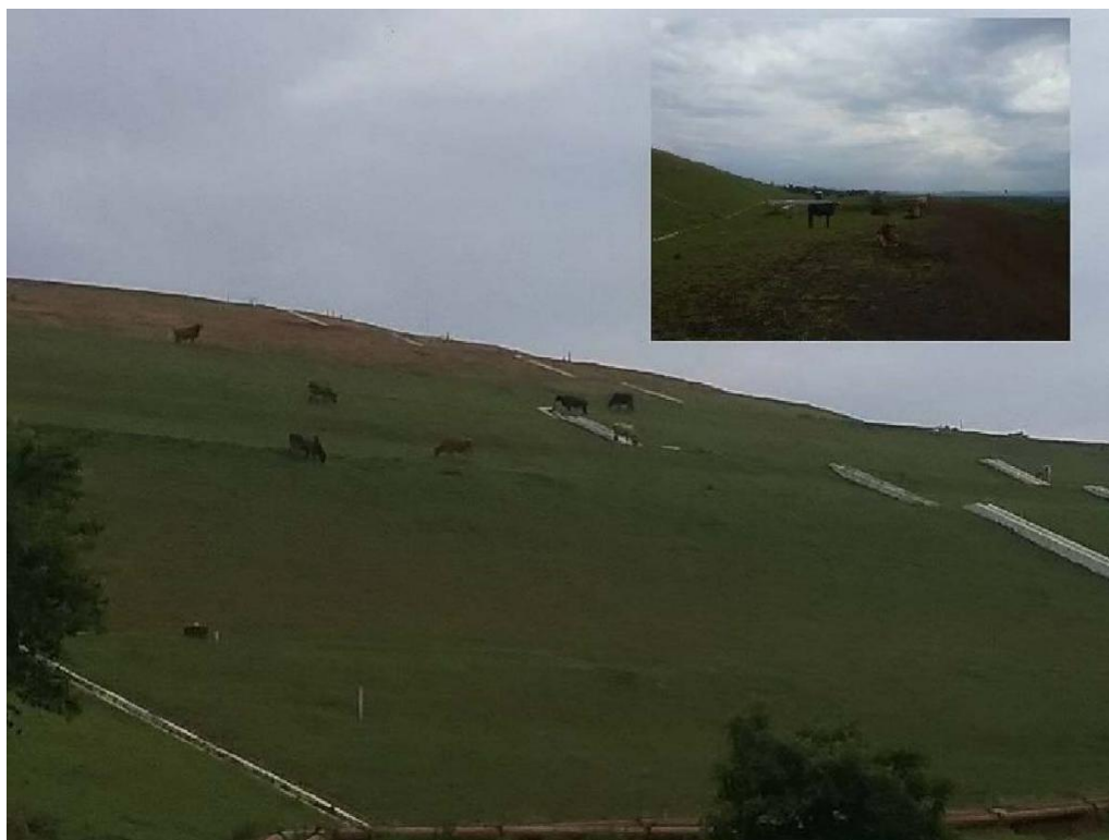
Figura 125: Gado no talude do barramento
