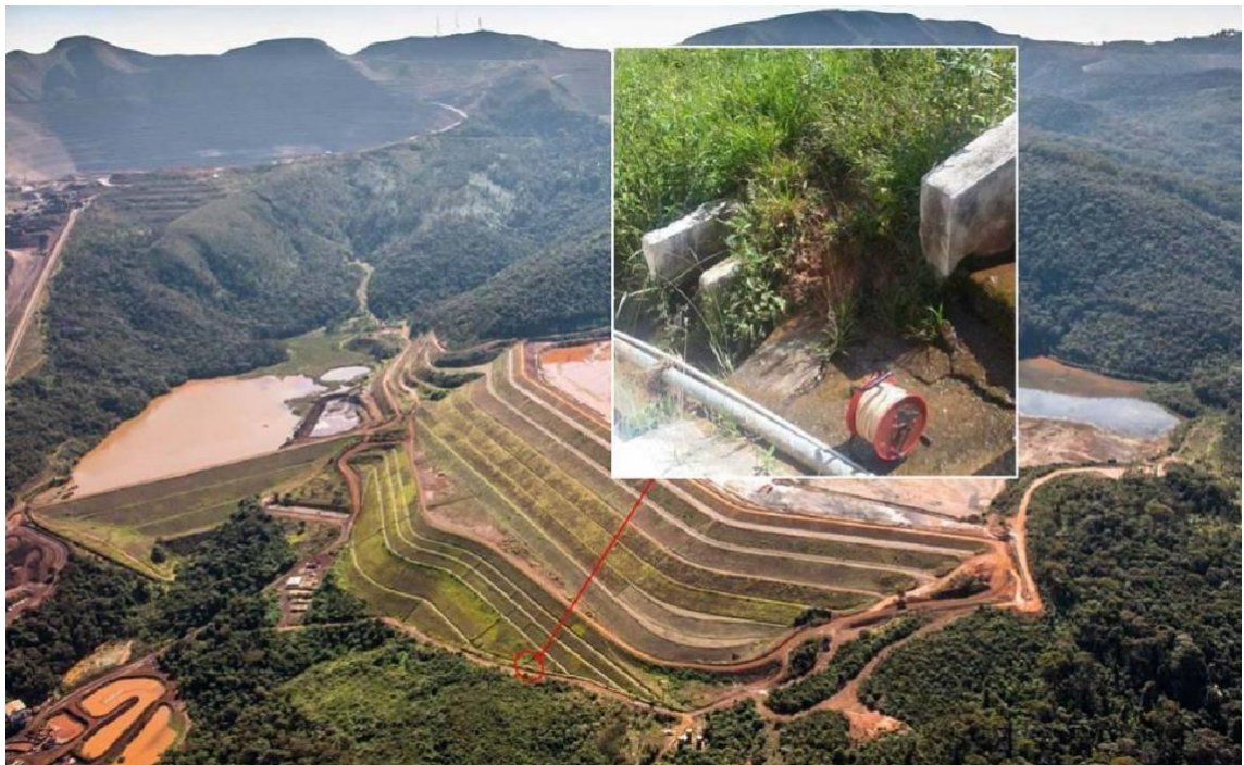
Figura 97: Surgência no talude do barramento
