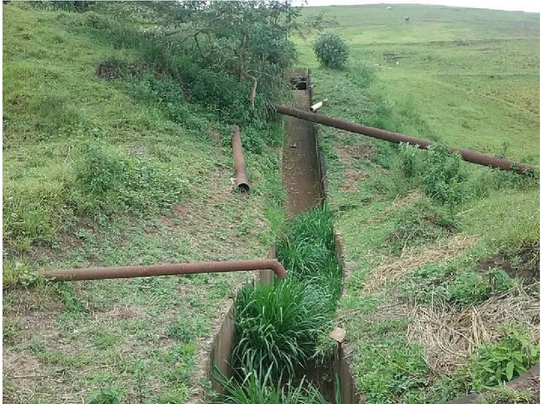
Figura 94: Obstrução de canaleta por vegetação
