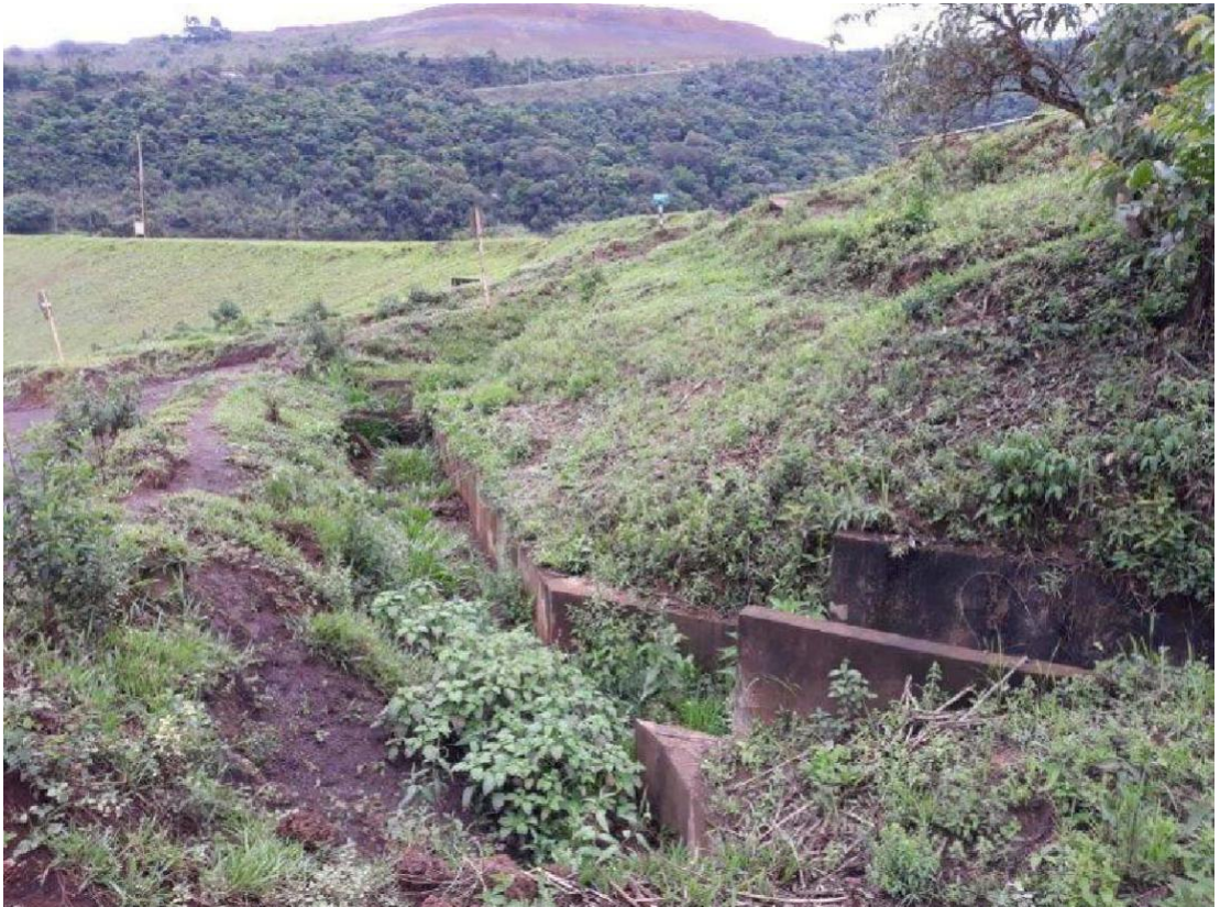
Figura 95: Vegetação arbus va no talude do barramento e dentro das canaletas de drenagem
