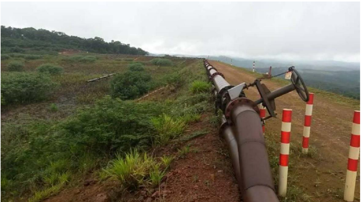
Figura 93: Vegetação arbus va no talude de montante e dentro do reservatório
