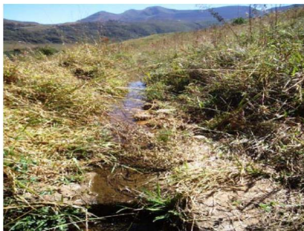
Figura 91: Vegetação alta obstruindo a canaleta de drenagem
