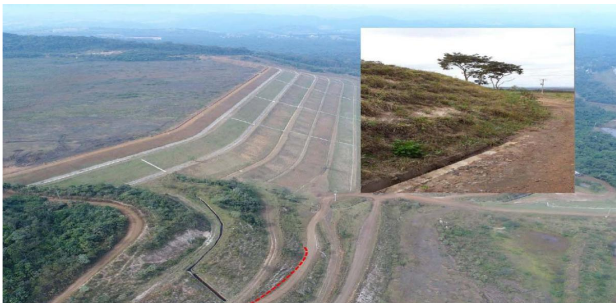
Figura 111: Canaleta de drenagem superficial assoreada
