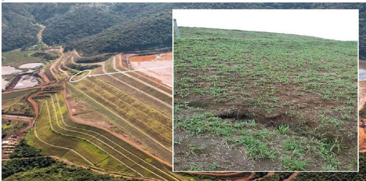
Figura 121: Ravinas na ombreira direita do talude
