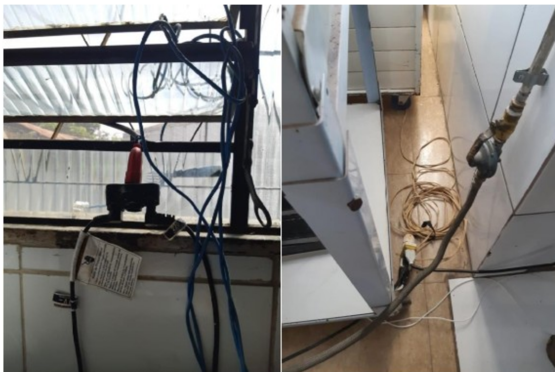
Foto 26 – Instalações elétricas improvisadas e precárias na padaria.
