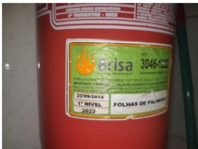
Foto 107 – Extintor de incêndio com recarga vencida.
