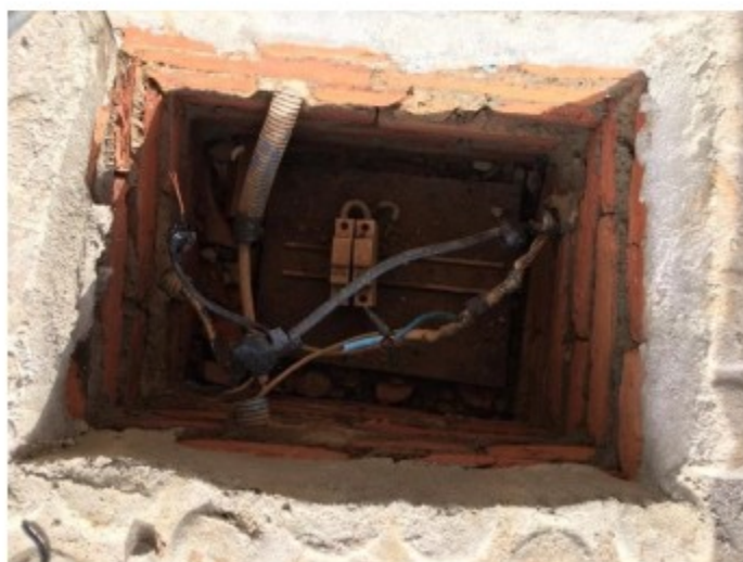
Foto 108 – Instalações elétricas precárias.
