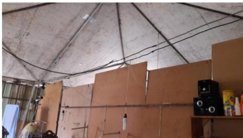
Foto 99 – Cobertura de lona e “meia parede” de madeirite, que separa a oficina de costura do alojamento e depósito de agrotóxicos. Destaque para a fiação e as lâmpadas utilizadas.
