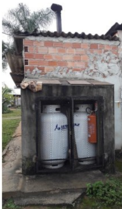
Foto 24 – Instalação para suprimento de gás da padaria.
