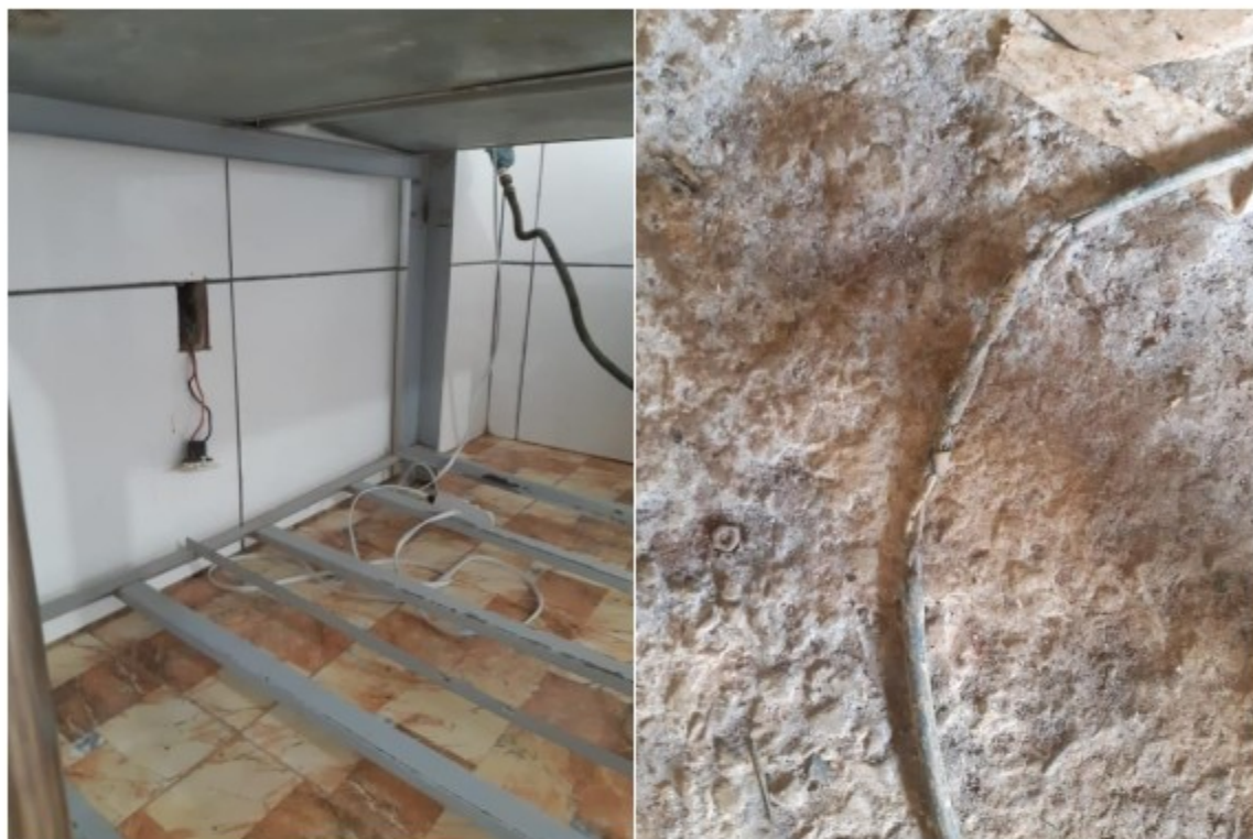
Foto 25 – Fiação elétrica exposta e com isolamento precário.
