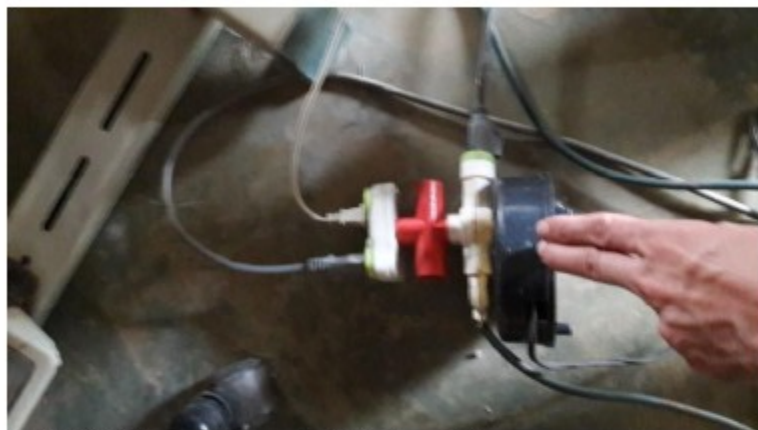
Foto 109 – Improvise nas instalações elétricas.
