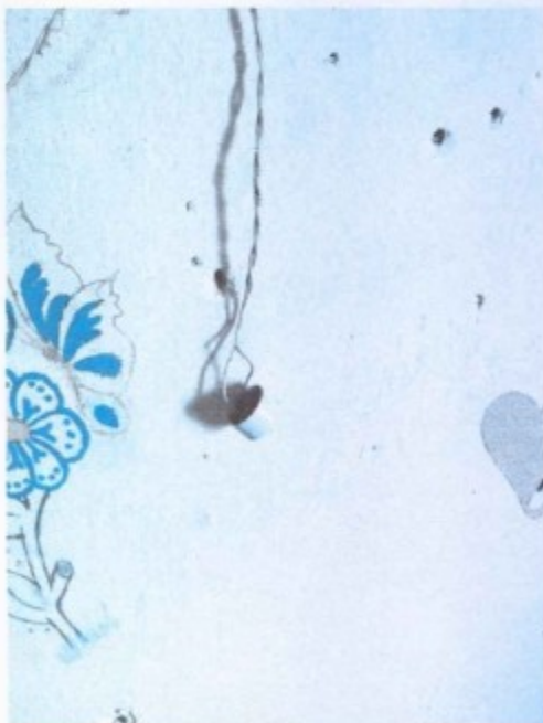
Condições das instalações elétricas e das paredes no alojamento onde estava o [REDACTED]
