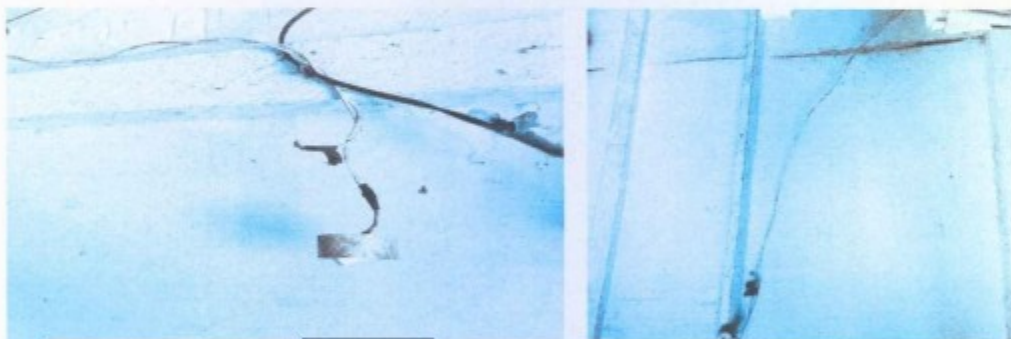
Foto do alojamento de [REDACTED] – fios com as partes vivas expostas (à esquerda) ou com o isolamento soltando. Risco de choques elétricos ou curto circuito.
