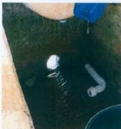
Tanque de lavagem de roupa desacoplado
