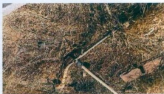
Tubulação de distribuição de água
