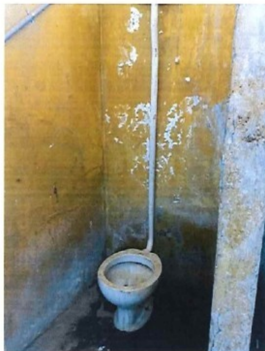
Im. 10. Detalhe do único vaso sanitário disponibilizado no alojamento da Faz. Patos. Registro efetuado em 18/07/2018.
