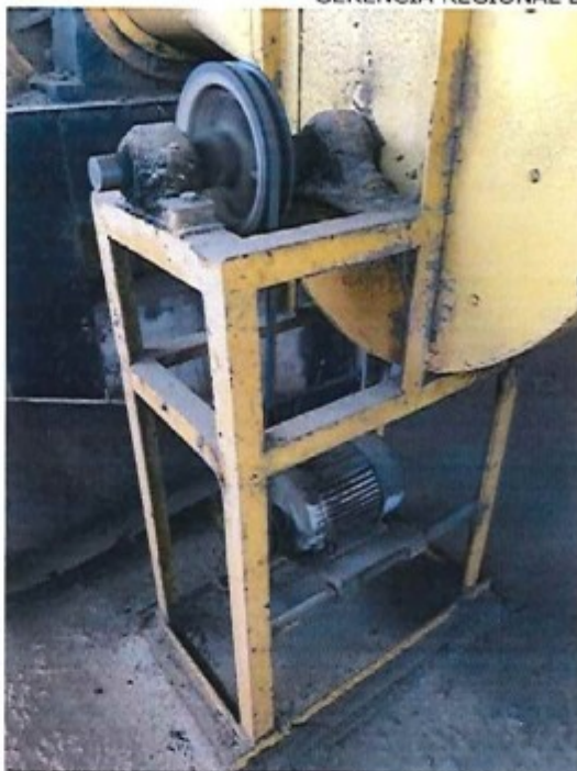
Im. 28. Maquinário na Faz. Congonhas com transmissões de força sem proteção. Registro efetuado em 19/07/2018.
