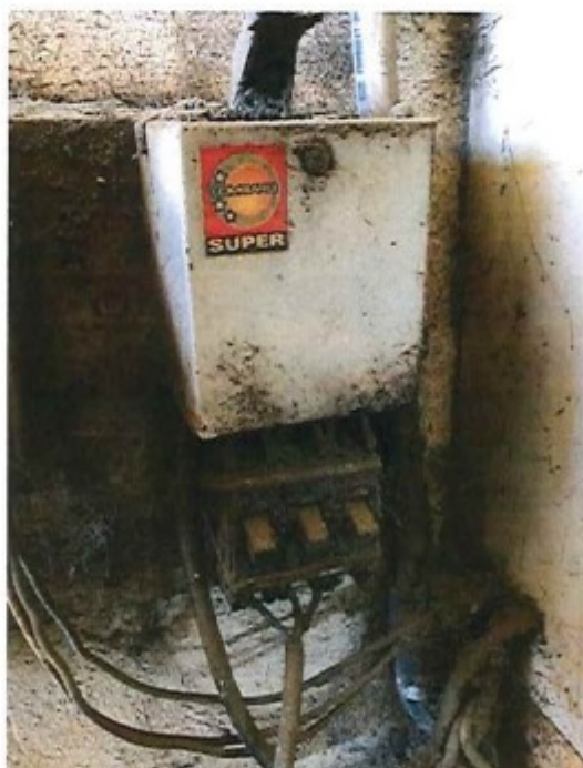
Im. 30. Disjuntor na Faz. Congonhas com partes energizadas expostas. Registro efetuado em 19/07/2018.
