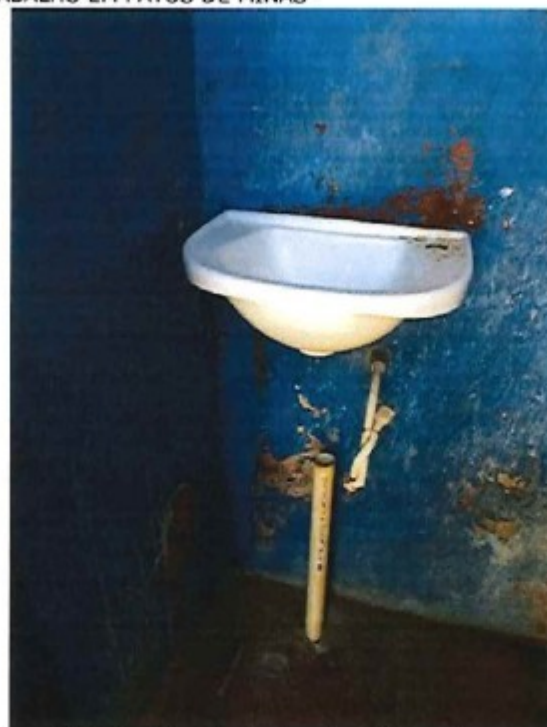
Im. 18. Detalhe do único lavatório existente nas instalações sanitárias do alojamento da Faz. Congonhas. Registro efetuado em 18/07/2018.
