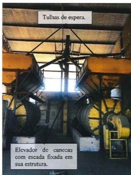
Im. 33. Vista do conjunto de secadores na Faz. Congonhas sem gaiola de proteção na escada de acesso à parte superior do elevador de canecas e sem plataforma de trabalho na tulha de espera. Registro efetuado em 19/07/2018.
