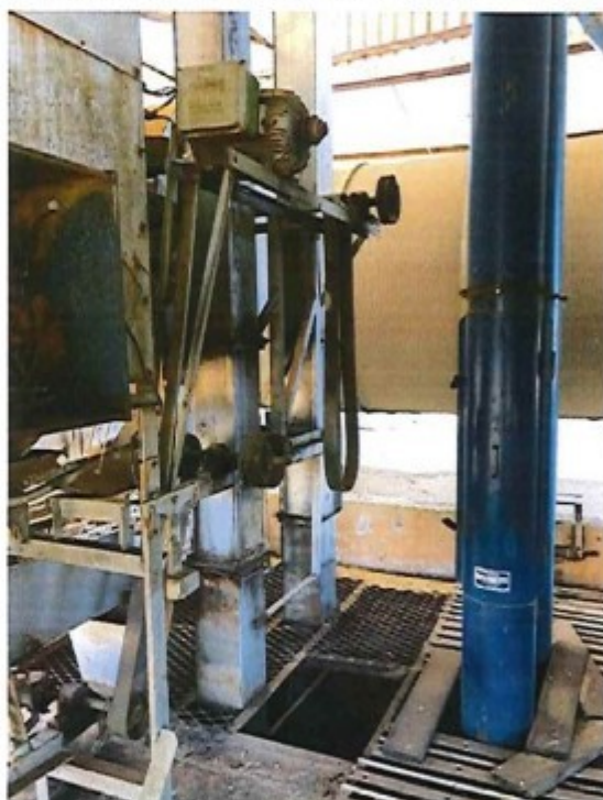
Im. 32. Detalhe de abertura no piso, sem proteção, no secador da Faz. Patos. Registro efetuado em 19/07/2018.
