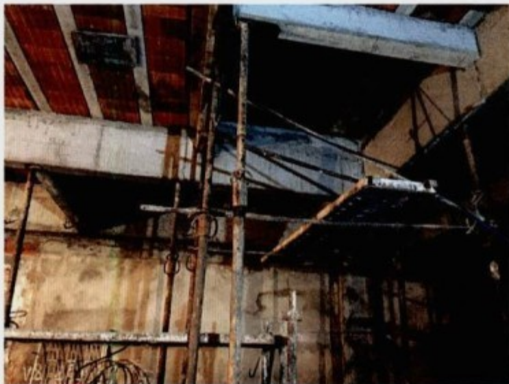
Figura 28 Andaime improvisado colocando em risco a integridade física do trabalhador.
