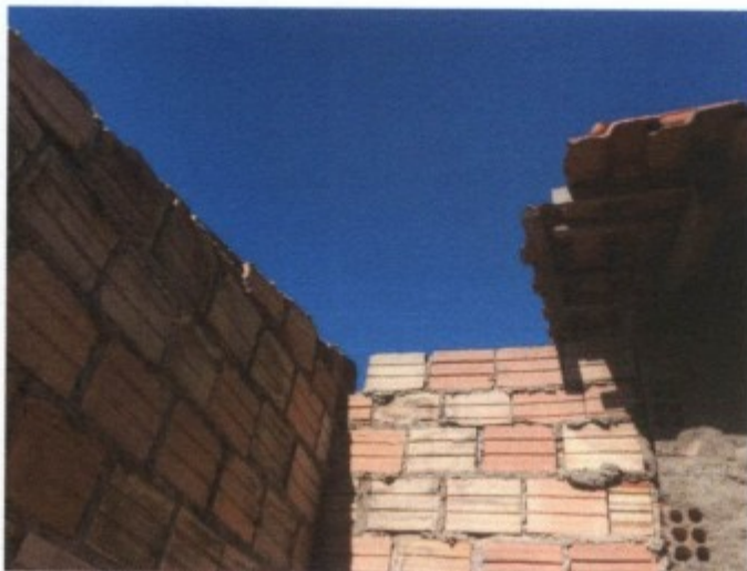
Foto: Não havia teto no 'banheiro'.
