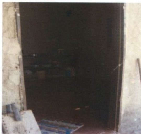
Foto: Não havia portas na entrada e nos fundos do alojamento.
