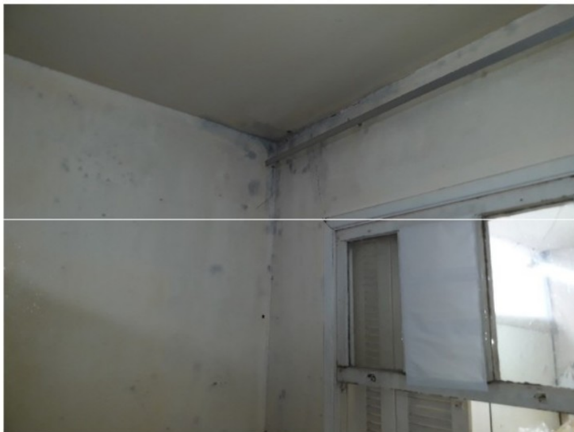
06/11/2018 - OFICINA DE COSTURA Nº 1 - quarto dos trabalhadores, coberto de mofo.
