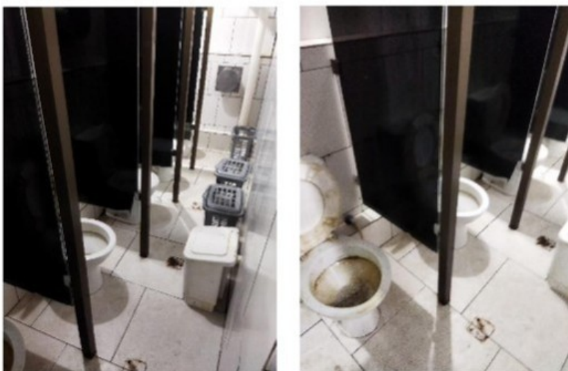
Gabinetes sanitários sem portas.
