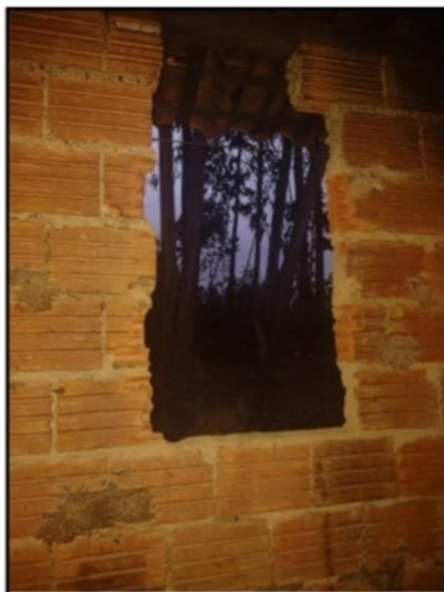
Foto 85 – Foto da abertura na parede da cozinha, não havia qualquer janela ou proteção para evitar a entrada de insetos e animais peçonhentos.
