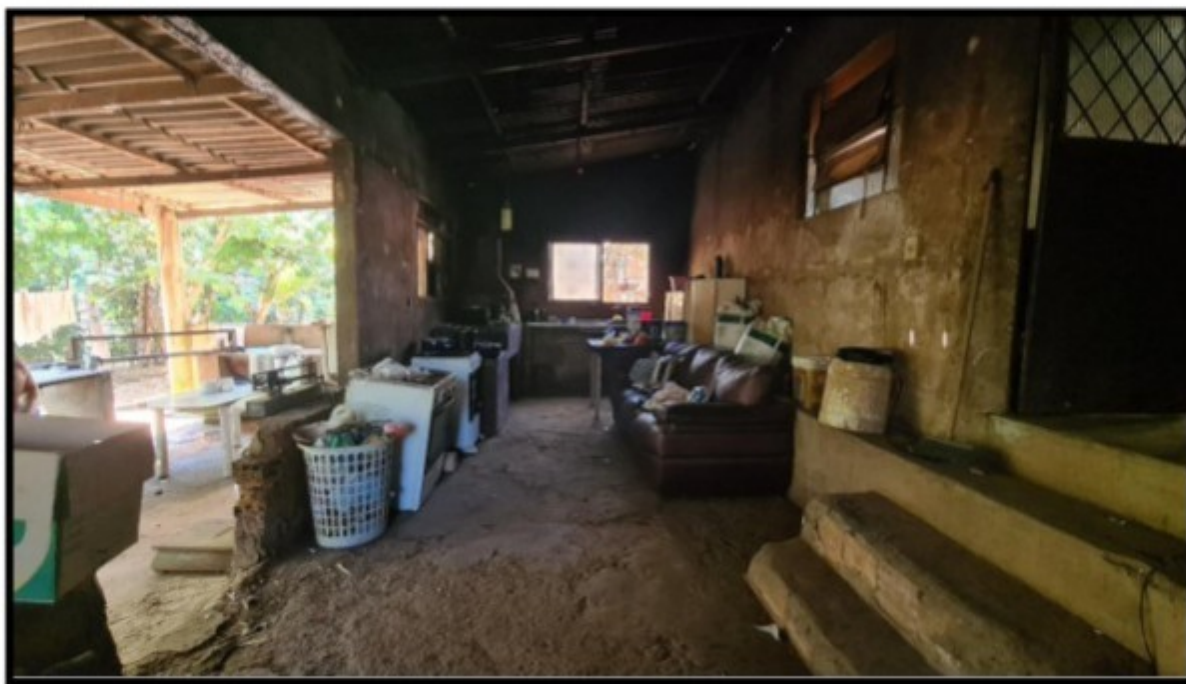
Foto 3: Vista da cozinha do alojamento, com piso irregular e ausência de paredes em todos os lados do ambiente
