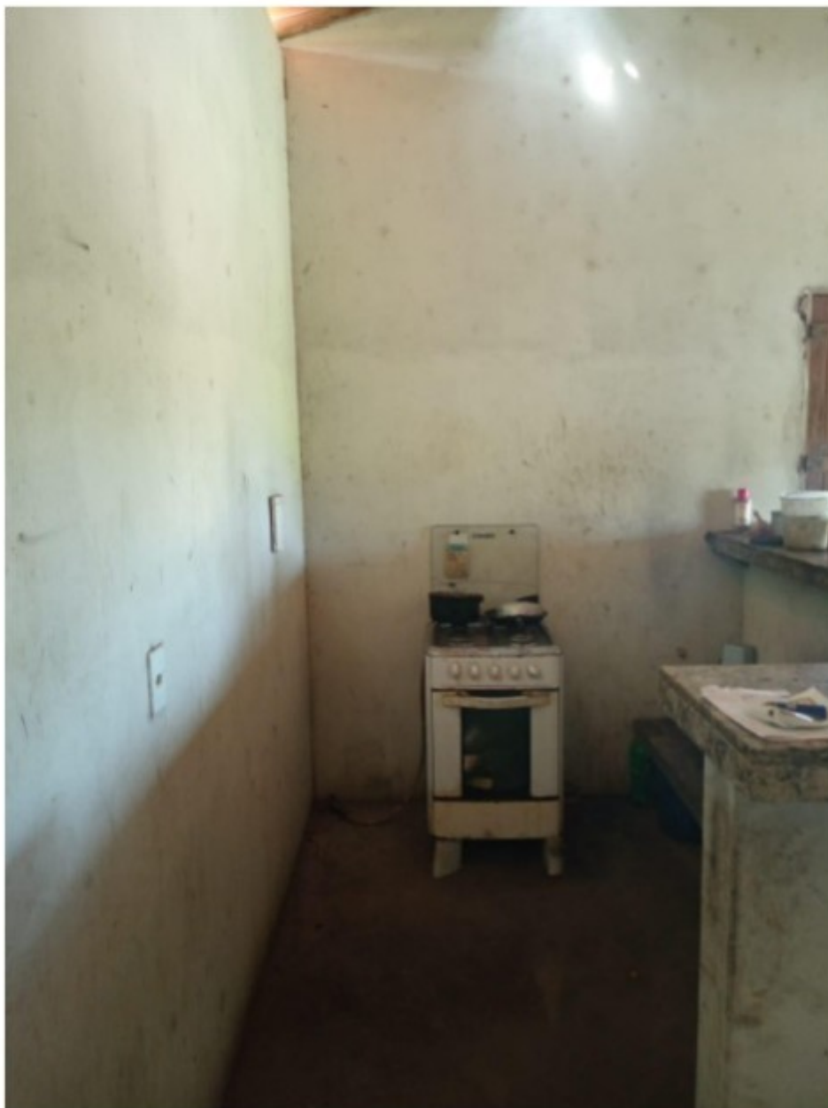
FOGÃO EXISTENTE NO LOCAL ONDE DEVERIA FUNCIONAR A COZINHA
