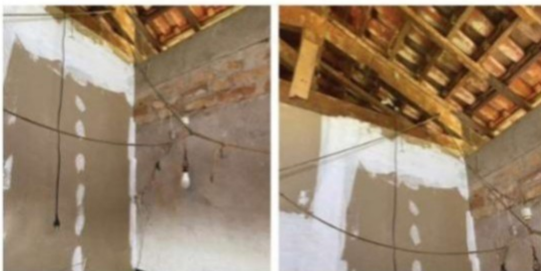
Fotos 49 e 50: Fotos instalação elétrica improvisada e ausência de forro no teto
