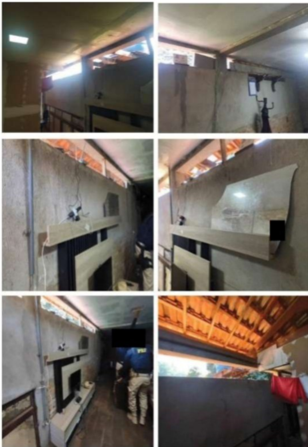
Fotos 51 a 56: Parede do alojamento não tinha fechamento completo.
