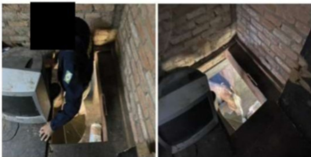
Foto 22 e 23: Foto da escada vista do interior do alojamento, nenhuma proteção na abertura de piso, no detalhe vemos um cavalo bem abaixo da escada
