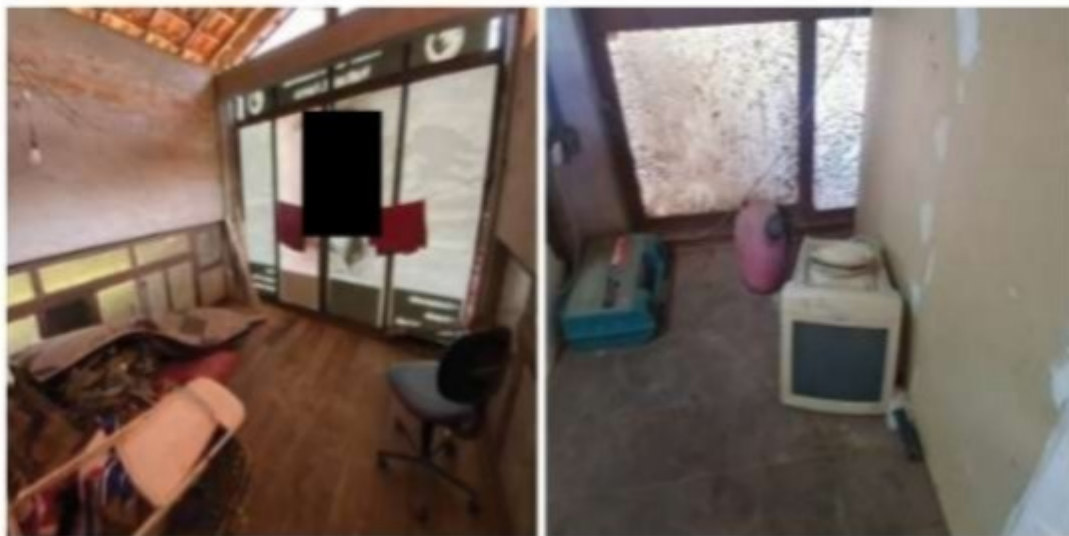
Fotos 47 e 48: Parte dos fundos do alojamento, muito entulho do chão
