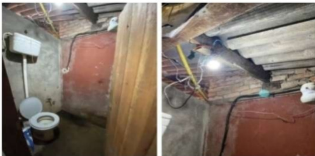
Fotos 76 e 77: Fotos do banheiro que ficava no interior do interior do alojamento de [REDACTED] No detalhe vemos a fiação elétrica improvisada.
