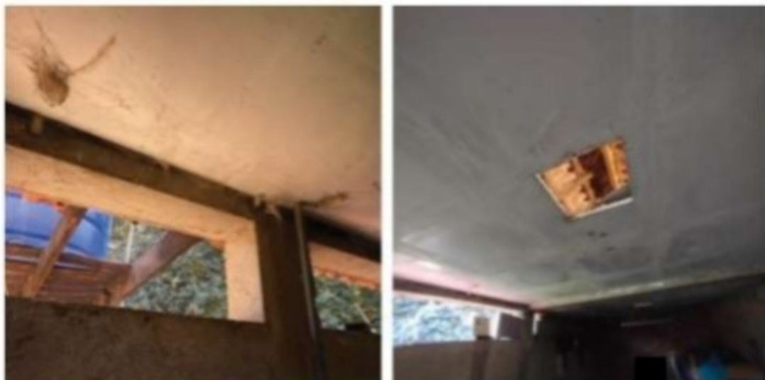
Fotos 57 a 58: Teias de aranha à esquerda e abertura no teto à direita
