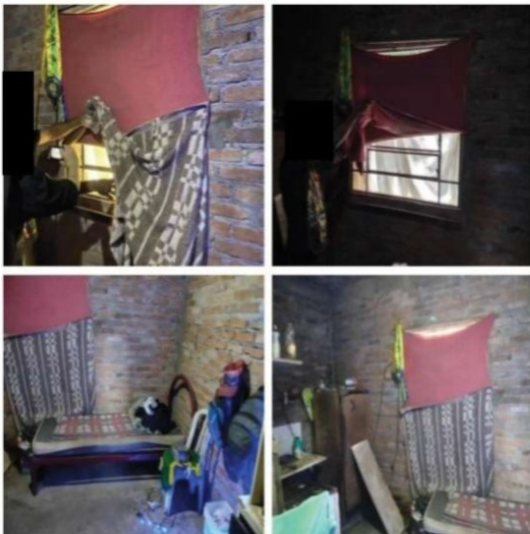
Fotos 102 a 105: Janela não possuía vidro, desta forma o trabalhador colocou cobertores para tapar a abertura da parede.
