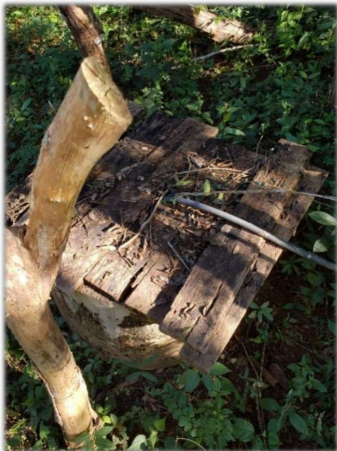
Figura 7 cisterna com tampa improvisada em tábuas de madeira
