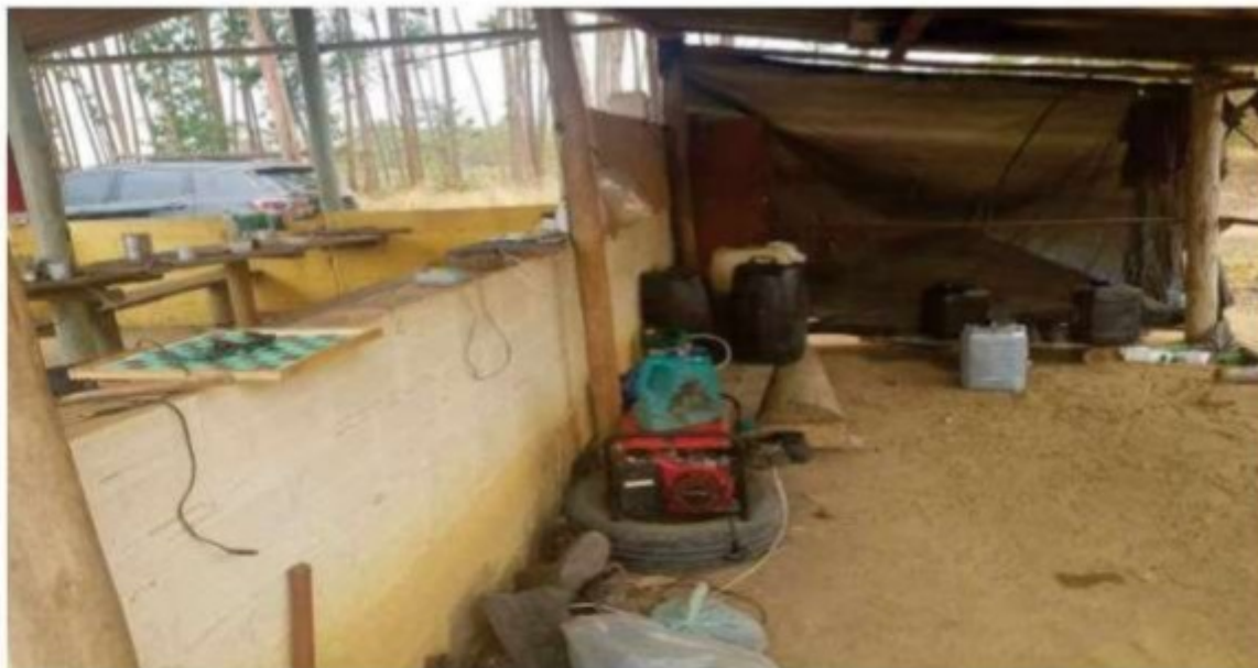
Figura 6: armazenamento de substâncias inflamáveis próximo a área de vivência
