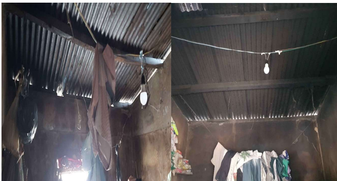
Figura 23: Fiação exposta sendo usada como varal; Figura 24: Soquete de lâmpada pendendo do teto.
