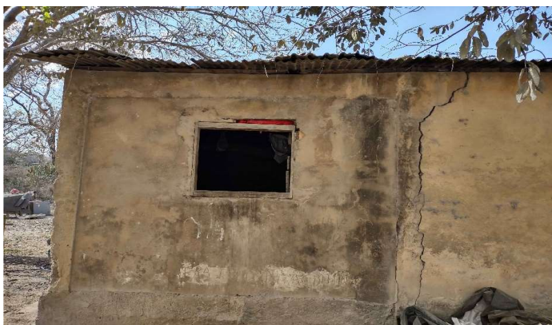
Figura 5: Parede com extensa rachadura na parte externa do barraco.
