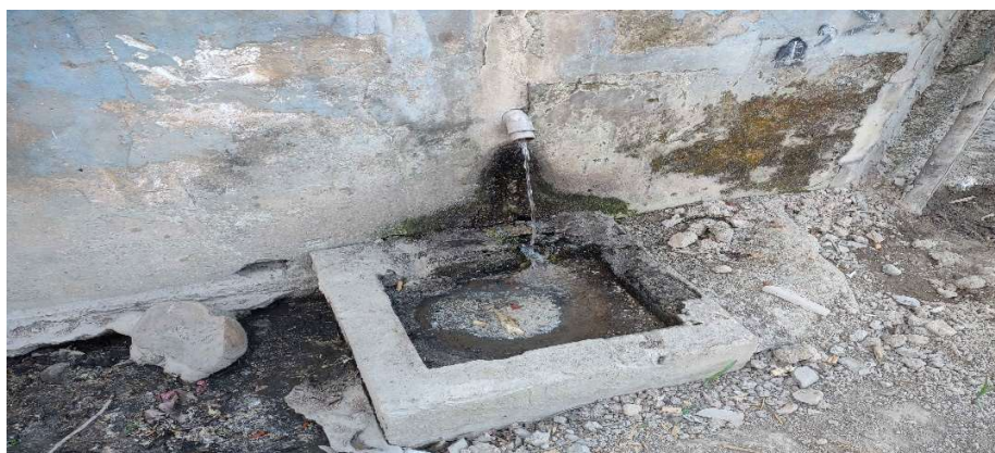
Figura 11: Caixa de cimento aberto onde era depositada a água com dejetos advindos da pia da cozinha.
