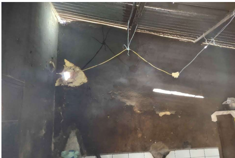
Figura 9: Buraco feito na parede da cozinha para a passagem da fiação elétrica.
