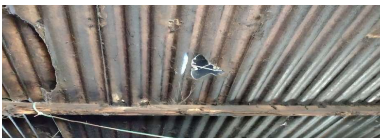
Figura 10: Buraco na cobertura de telhas de amianto.
