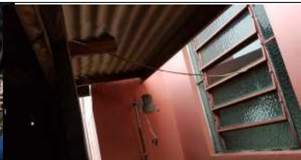
Chuveiro instalado em área externa para o banho de mãe e filha.
