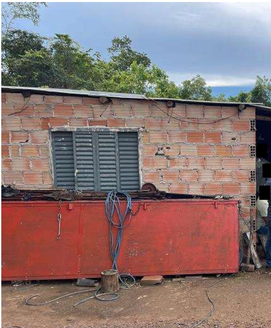
Entulho na frente do alojamento que impedia a abertura da janela do alojamento do Barracão
