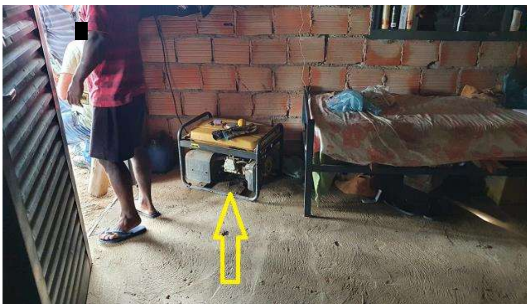
Gerador de energia dentro do alojamento da Fazenda Buracão
