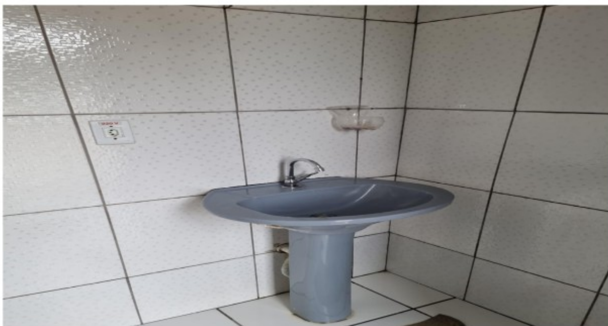
Foto 20: PÁTIO/GARAGEM da empresa TRANSPORTADORA SIDER. Única instalação sanitária existente no local de espera, de repouso e de descanso dos motoristas profissionais empregados da empresa, utilizada por homens e mulheres. Dentro da única estrutura havia 1 (um) lavatório, sem sabonete e sem papel.
