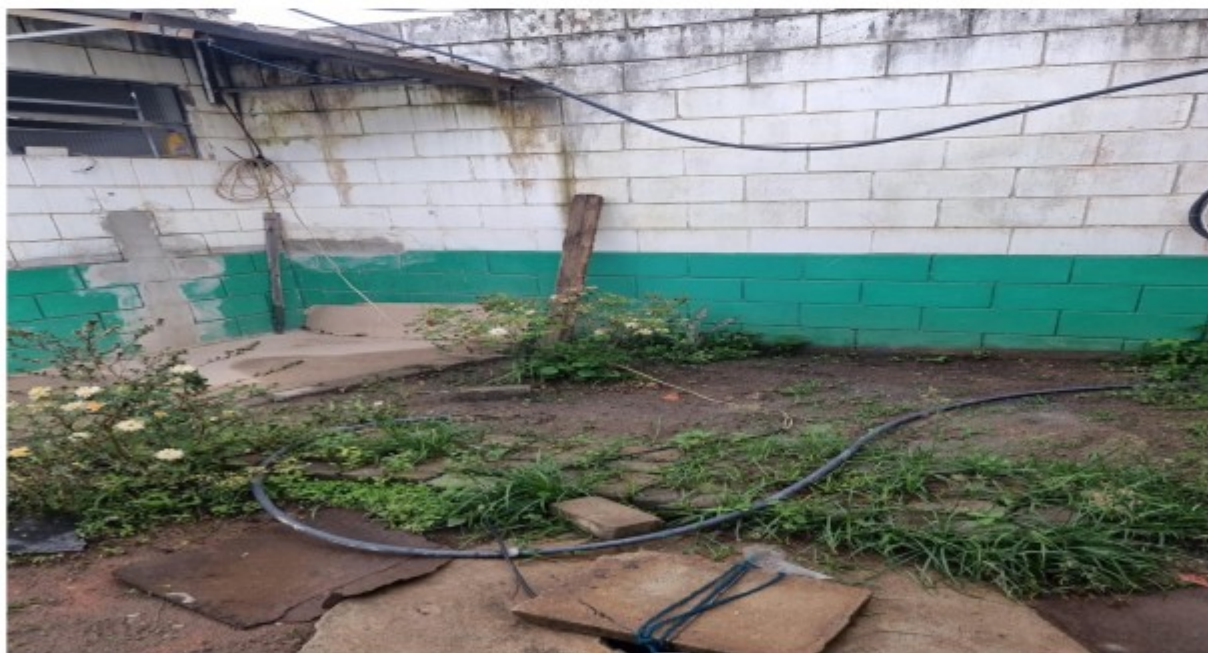
Foto 10 - PÁTIO/GARAGEM da empresa TRANSPORTADORA SIDER. Instalação elétrica improvisada e desprotegida. Estrutura precária no local de espera, de repouso e de descanso dos motoristas profissionais empregados da empresa.
