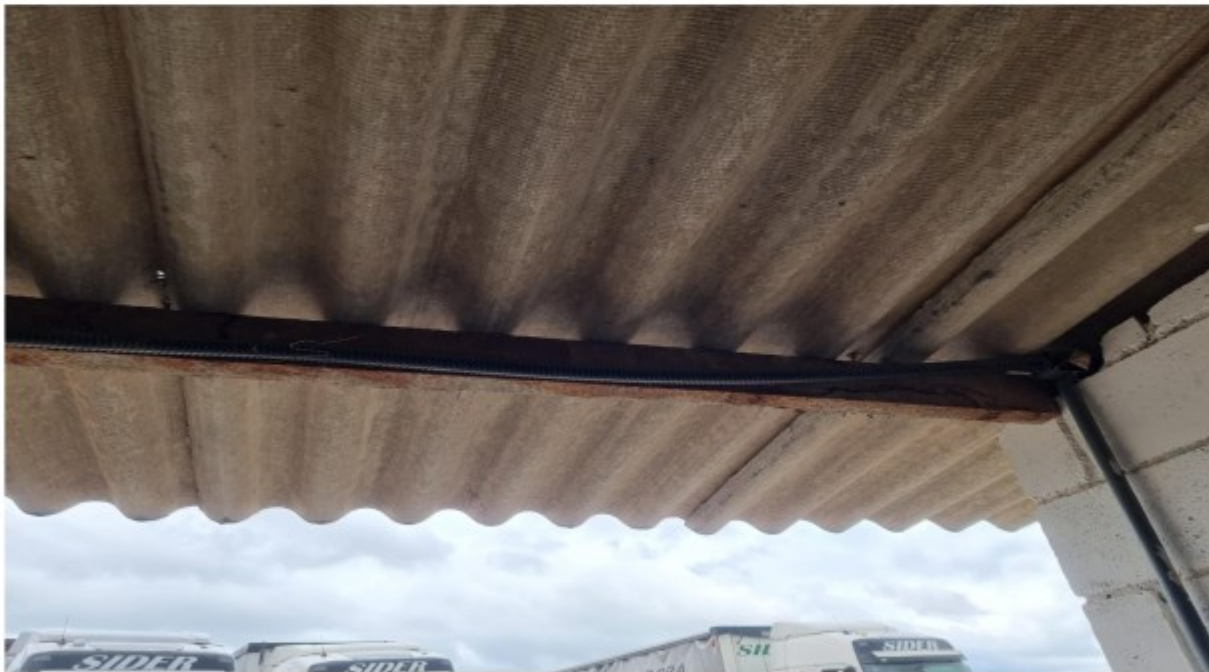
Foto 08: PÁTIO/GARAGEM da empresa TRANSPORTADORA SIDER. Instalação elétrica improvisada. Estrutura precária, com telhas sobre madeira, com iluminação precária, no local de espera, de repouso e de descanso dos motoristas profissionais empregados da empresa.
