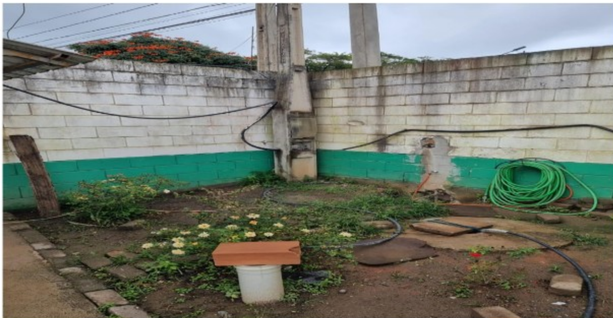
Foto 11: PÁTIO/GARAGEM da empresa TRANSPORTADORA SIDER. Instalação elétrica improvisada e desprotegida. Estrutura precária no local de espera, de repouso e de descanso dos motoristas profissionais empregados da empresa.
