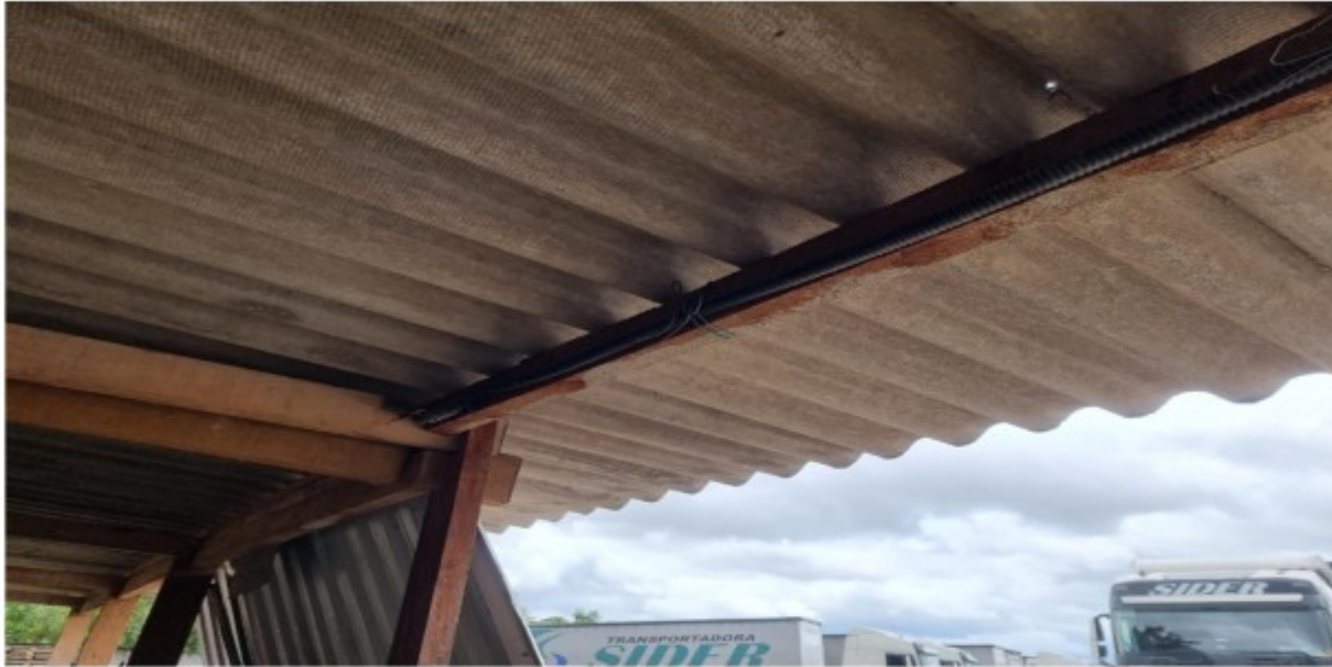
Foto 07: PÁTIO/GARAGEM da empresa TRANSPORTADORA SIDER. Instalação elétrica improvisada. Estrutura precária, com telhas sobre madeira, com iluminação precária, no local de espera, de repouso e de descanso dos motoristas profissionais empregados da empresa.
