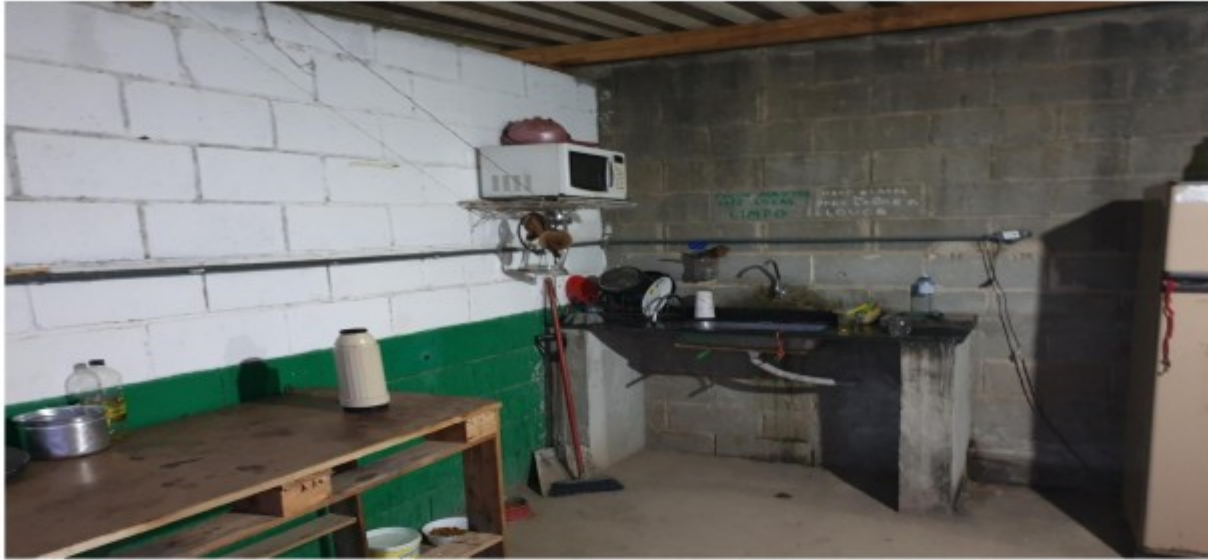
Foto 05: PÁTIO/GARAGEM da empresa TRANSPORTADORA SIDER. Estrutura precária, com iluminação precária, no local de espera, de repouso e de descanso dos motoristas profissionais empregados da empresa. Local onde funcionava o refeitório, "lavanderia", aquecimento de refeições. A única geladeira não funcionava. Na primeira visita da Inspeção do Trabalho, não havia bebedouro ou filtro de água; após exigência da fiscalização, foi instalado um bebedouro no local.
