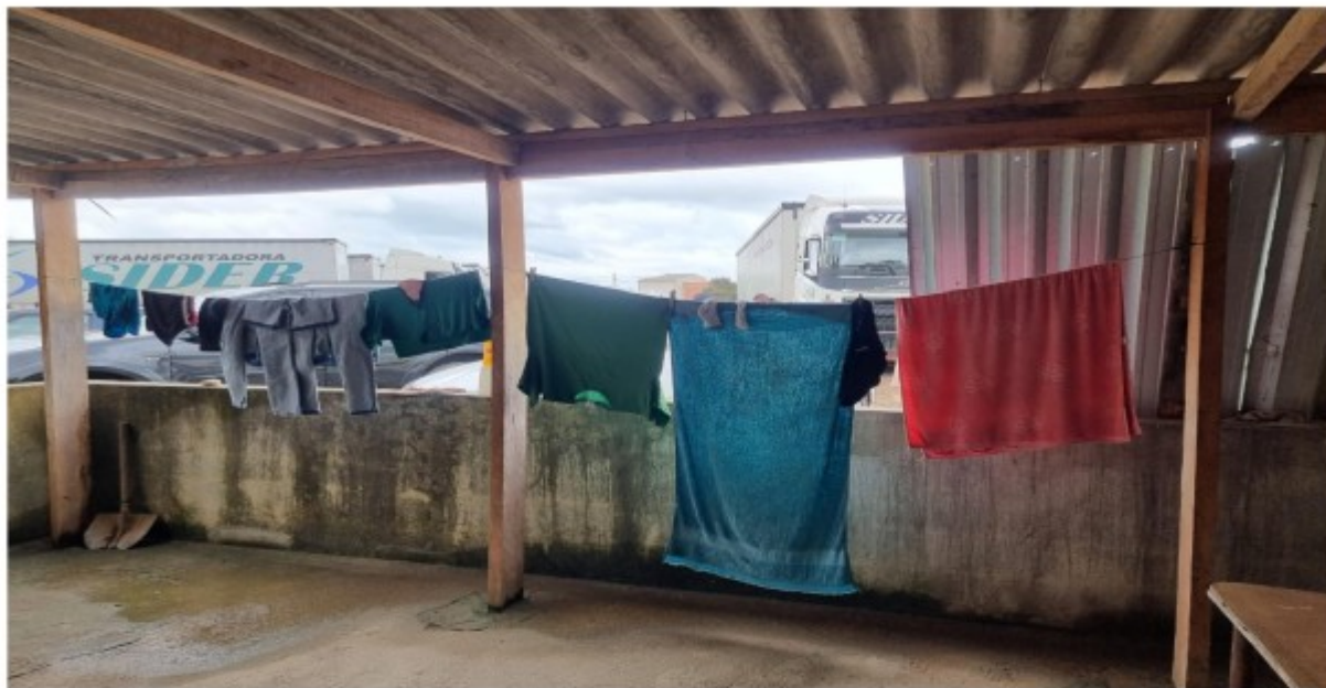
Foto 03: PÁTIO/GARAGEM da empresa TRANSPORTADORA SIDER. Estrutura precária, com iluminação precária, no local de espera, de repouso e de descanso dos motoristas profissionais empregados da empresa. Local onde funcionava o refeitório, “lavanderia” aquecimento de refeições. O local também servia para secagem das roupas após higienização.
