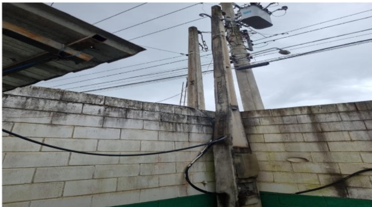
Foto 09: PÁTIO/GARAGEM da empresa TRANSPORTADORA SIDER. Instalação elétrica improvisada e desprotegida. Estrutura precária junto a rede elétrica, no local de espera, de repouso e de descanso dos motoristas profissionais empregados da empresa.
