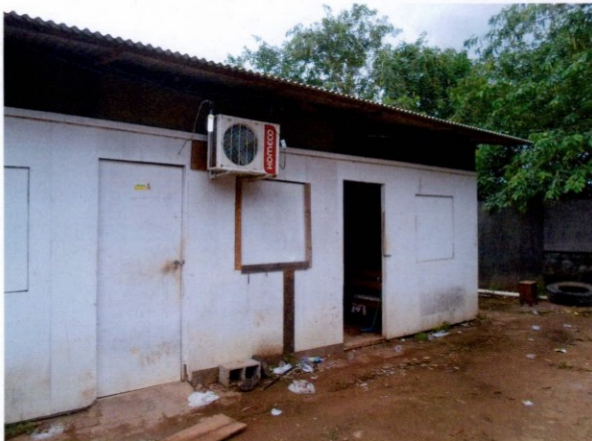
Foto 03 – sujeira acumulada em razão da falta de manutenção dos alojamentos
