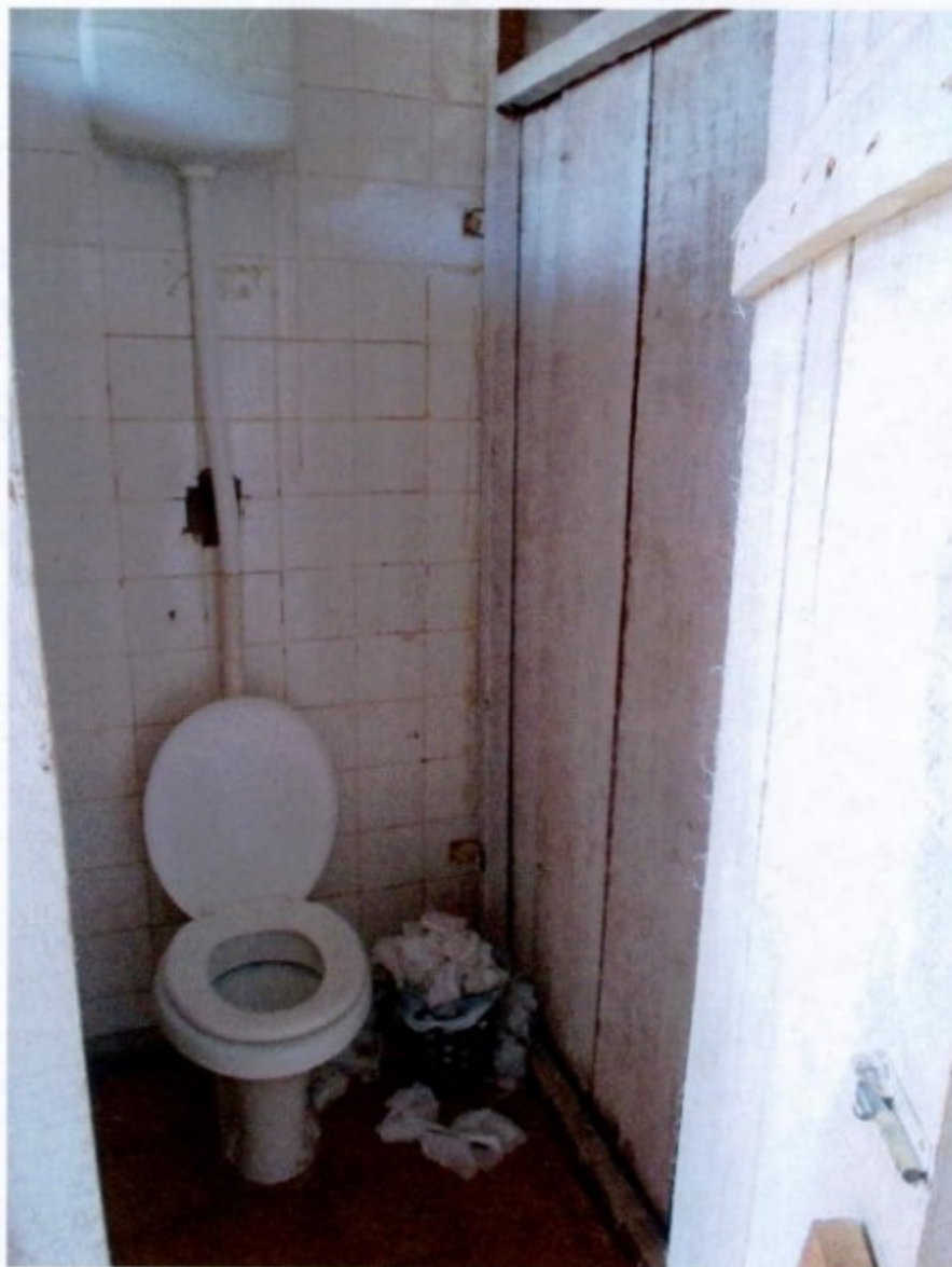
Foto 04 – Instalações sanitárias sem adequada higienização
