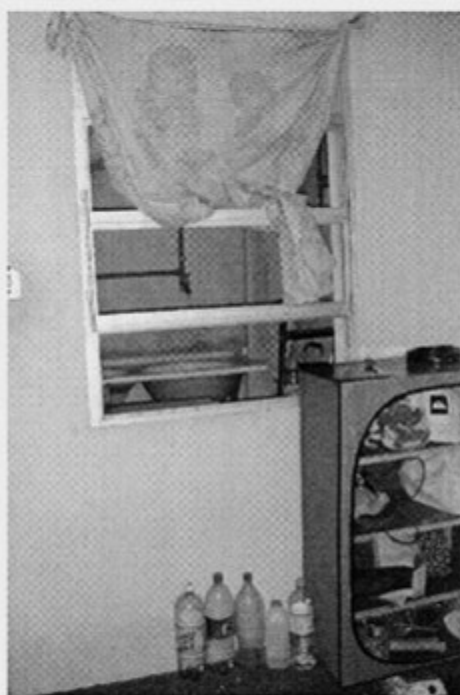
Janela do quarto onde trabalhador dormia estava sem vidro
