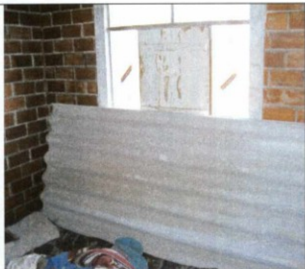
Um dos quartos utilizados pelos trabalhadores, com vedação improvisada com telha.
