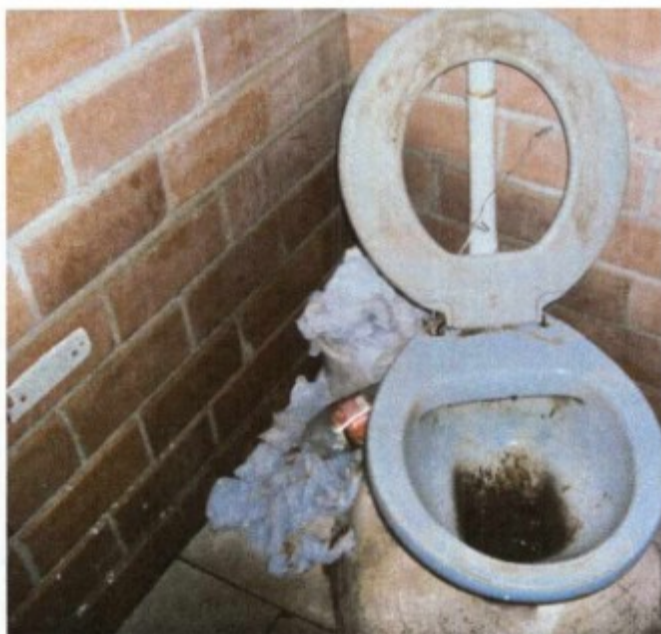
Detalhe do vaso sanitário, que não estava em uso há alguns dias, forçando os trabalhadores a utilizar o mato nos fundos da casa como local para satisfação de suas necessidades fisiológicas.
