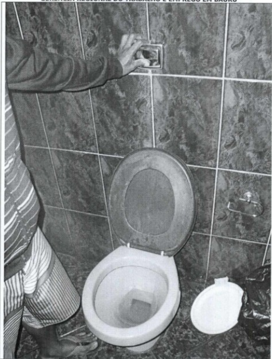
Imagem 01 – Descarga do banheiro sendo acionada e não funcionando (não proporcionava a descarga de água para destinação adequada dos dejetos), não oferecendo condições mínimas de higiene.
