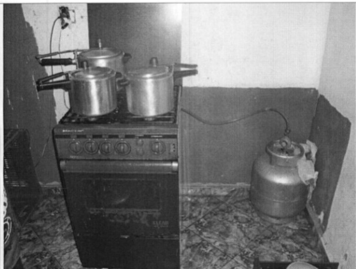
Imagem 01 –Fogão ligado ao botijão de gás instalados dentro do alojamento e utilizado pelos trabalhadores.
