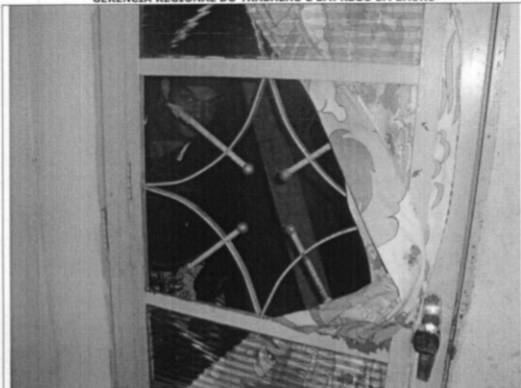
Porta do alojamento sem o vidro do meio, deixando de oferecer adequada vedação contra a entrada de vento e frio.
