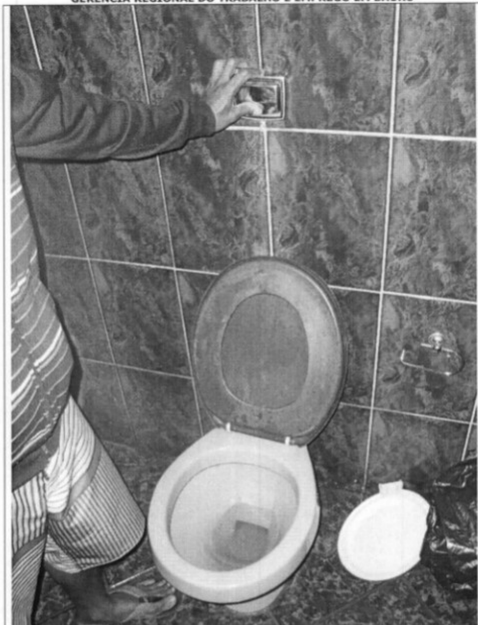
Imagem 01 – Descarga do banheiro sendo acionada e não funcionando (não proporcionava a descarga de água para destinação adequada dos dejetos), não oferecendo condições mínimas de higiene.
