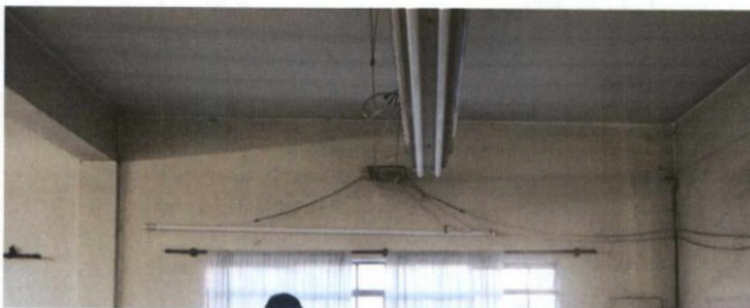
18/06/2013 - oficina de costura sob gerenciamento de [REDACTED] [REDACTED] "Gambiarras" elétricas para alimentação das luminárias. risco de curto-circuito e incêndio.
