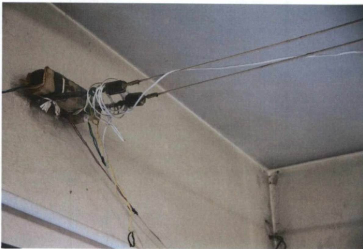
18/06/2013 - oficina de costura sob gerenciamento de [REDACTED] [REDACTED] "Gambiarras" elétricas para alimentação das máquinas de costura, em contato direto com material altamente inflamável (papelão). risco de curto-circuito e incêndio.
