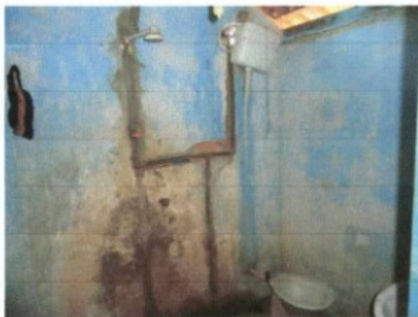
Foto 1 - Instalação sanitária precária
