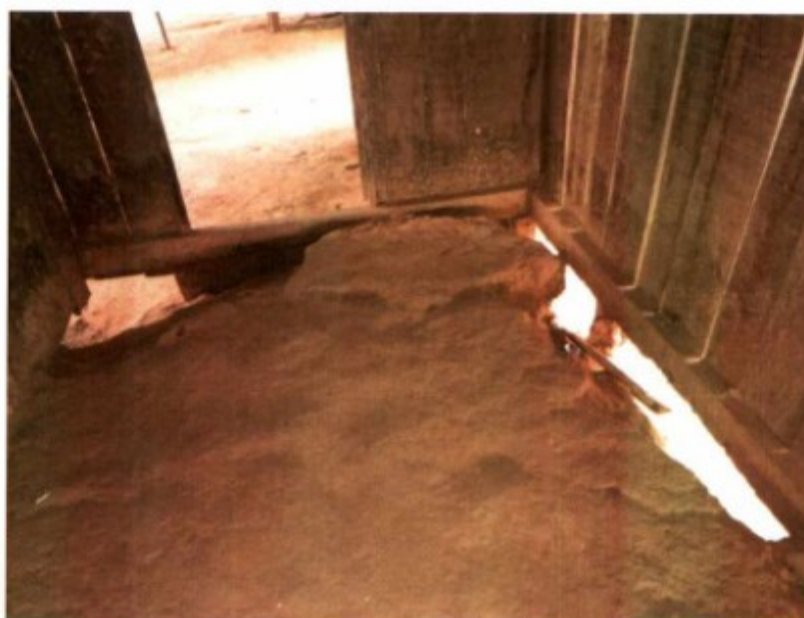
Foto 6: Buracos no chão por onde podem passar animais peçonhentos
