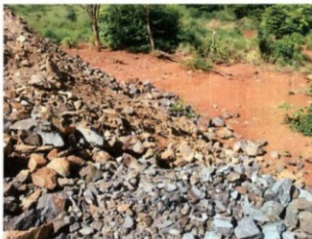
Falta de proteção dos taludes
