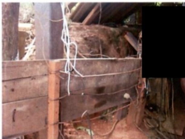
Quadro de comando elétrico sem proteção e com várias emendas desprotegidas.
