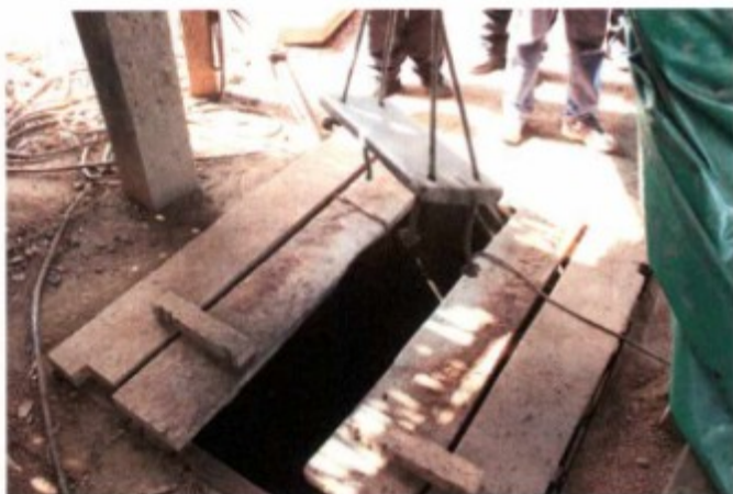
Poço sem isolamento e sinalização da área.
