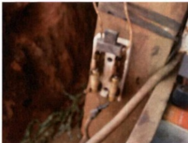
Dispositivo elétrico sem isolamento expondo as partes vivas.
