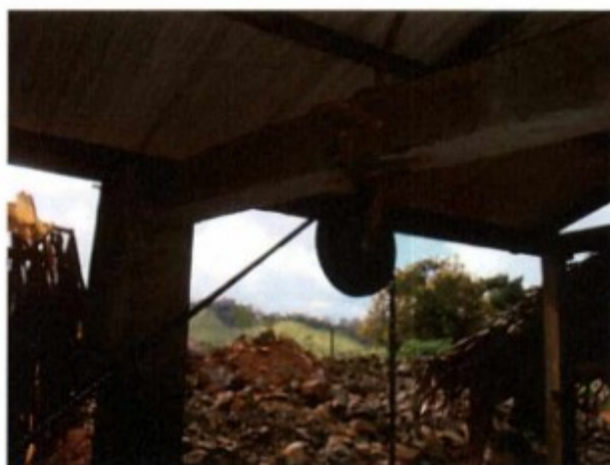
Fixação do guincho em uma estrutura de madeira sem qualquer informação quanto aos limites de carga.
