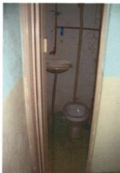
Banheiro em condições sanitárias inadequadas..
