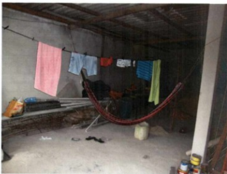
Instalações elétricas precárias no interior dos cômodos.
