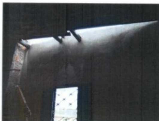
Área de vivência do alojamento convivendo com obras de construção, permitindo a entrada de umidade e água.
