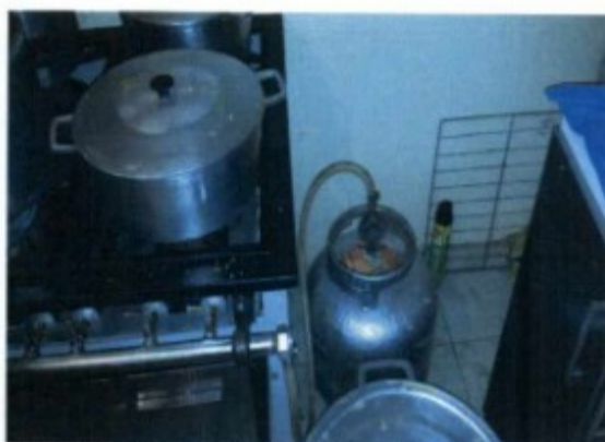
Botijão de gás em área que servia de cozinha e alojamento.
