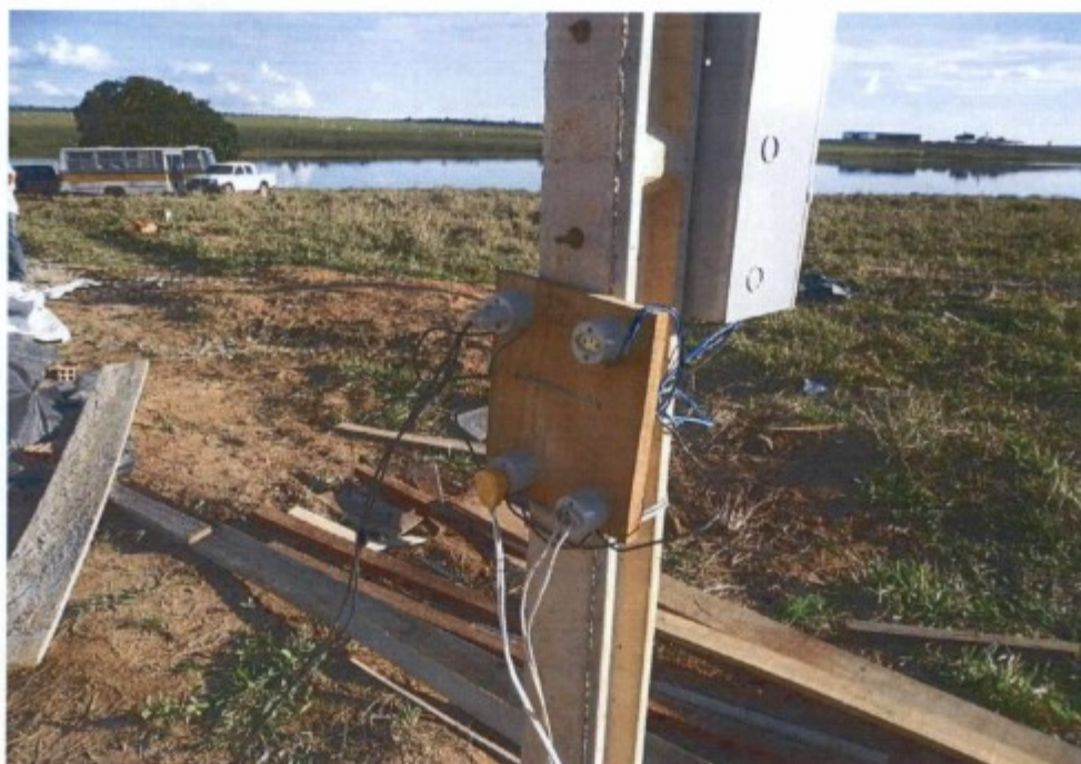
Fig.: Instalação elétrica precária no canteiro de obras.
