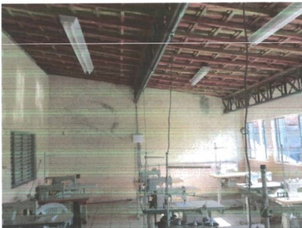
Regularização da fiação, limpeza e organização do ambiente promovida pelo empregador após compromisso assumido com o GEFM
