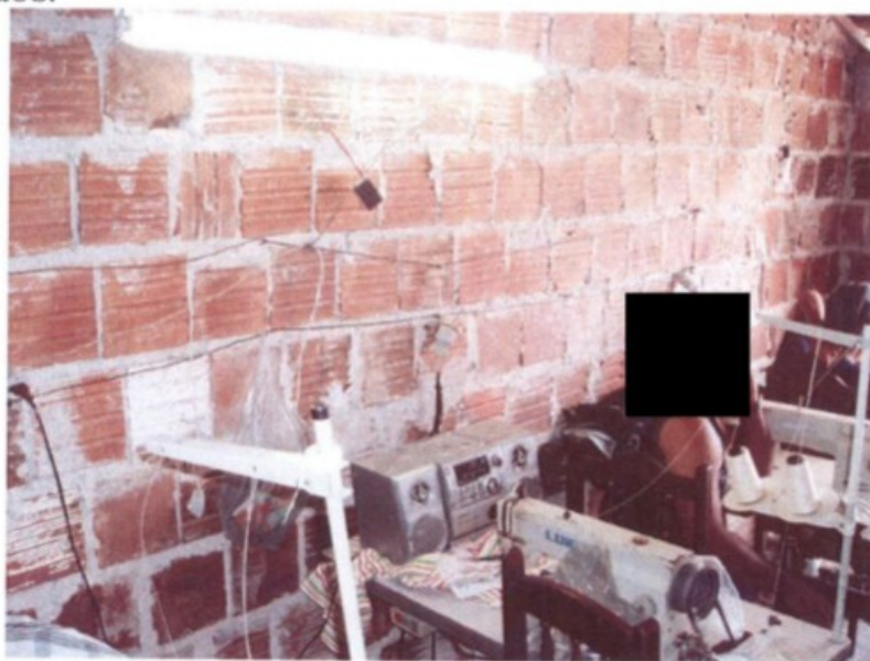
Foto 6. Instalações elétricas improvisadas próximo ao posto de trabalho.
