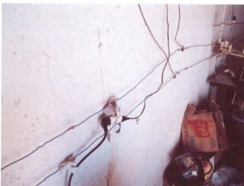
Fotos 2 e 3: gambiarras das instalações elétricas da facção do [REDACTED]
