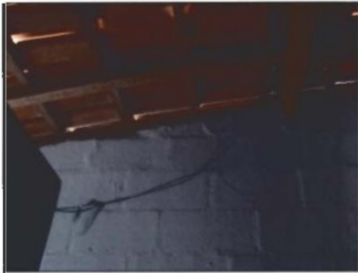
Instalações elétricas precárias no interior dos cômodos.
