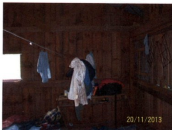
Foto 13: outro quarto sem condições de habitabilidade
