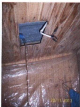
Foto 7: banheiro sem o chuveiro e com a fiação elétrica exposta
