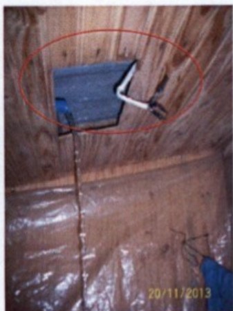
Foto 14: instalação elétrica de um dos chuveiros (ausente) no qual a água se aproxima das fiações expostas
