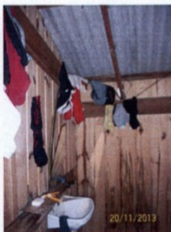
Foto 3: banheiro em péssimas condições de higiene
