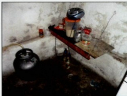
Detalhe do encanamento (sob a prateleira com mantimentos improvisada com tábua e arame), possivelmente utilizado, no passado, para instalação de vaso sanitário.
