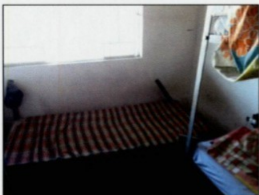
Estrutura metálica disponibilizada como cama, sem rigidez, com os montantes tombados.
