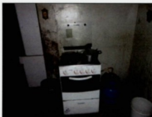
Outra cozinha, onde havia quatro botijões no interior do cômodo, um deles dentro de um armário. Detalhe do precário estado de conservação e limpeza da parede, que não possuía revestimento impermeável e lavável.
