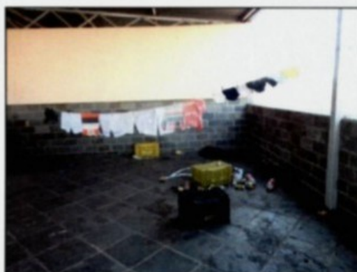
Precário estado de limpeza em área de serviço, com lixo espalhado e piso impregnado de sujeira.
