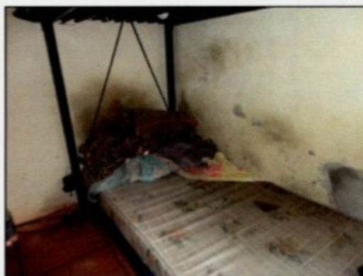
Paredes em precário estado de limpeza e conservação; colchão e roupas de cama em precário estado asseio e higiene.
