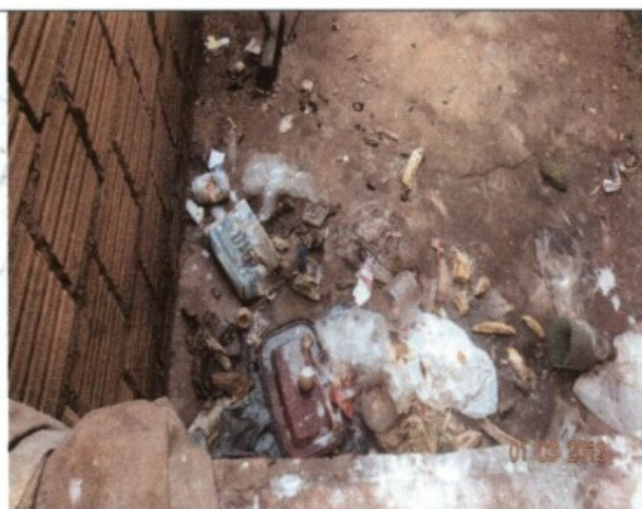
Lixo acumulado na área externa do alojamento.
