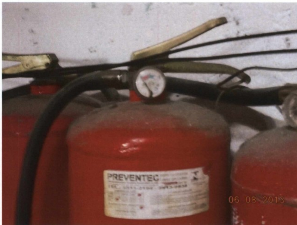
EXTINTORES DE INCÊNDIO VENCIDOS NO ALOJAMENTO.
