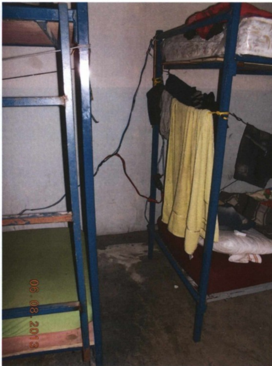
instalações elétricas improvisadas - "gambiarras" no alojamento.
