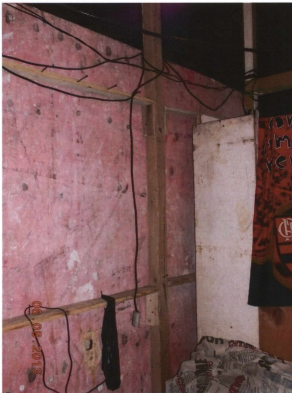
"GAMBIARRAS" COM SUPORTE EM MATERIAL INFLAMÁVEL (MADEIRA) - RISCO GRAVE E IMINENTE DE INCÊNDIO..
