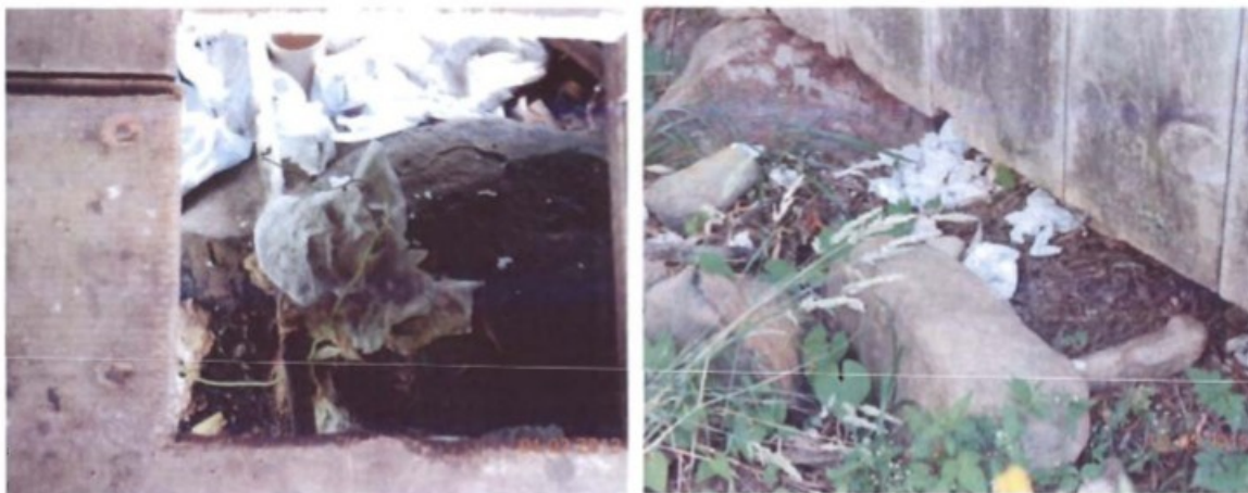
Instalação sanitária na frente de trabalho – ausência de cesto de lixo, água e sabão para higienização das mãos.
