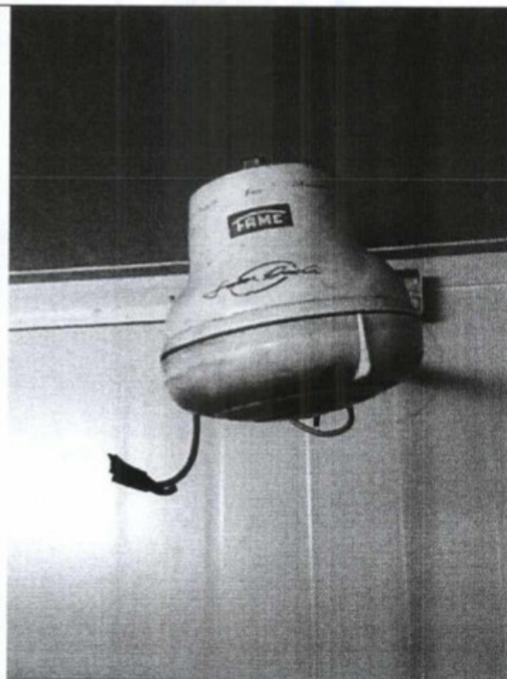
Foto 02: Chuveiro existente na instalação sanitária masculina sem ligação à rede elétrica. Ausência de chuveiro na instalação sanitária feminina.
