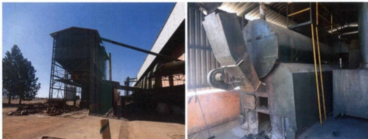
Fotos 13 e 14 – Caldeira na sede da Agromen sendo operada por trabalhadores sem treinamento para tal conforme exige a NR-13.
