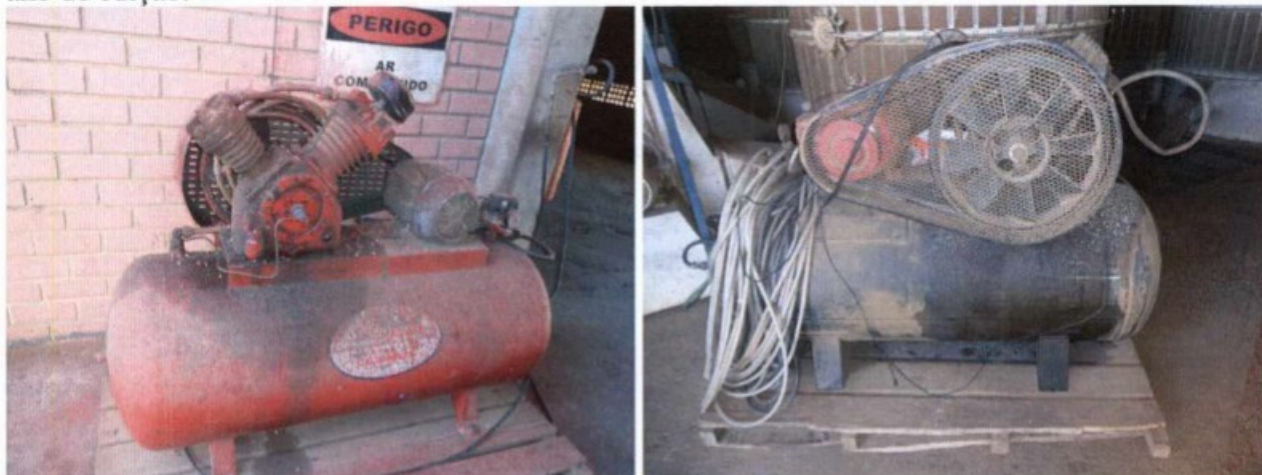
Fotos 15 e 16 – vasos de pressão sem placa de identificação
