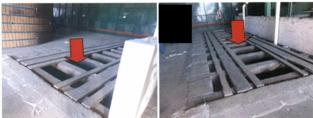
Fotos 7 e 8 - local (moega) de descarregamento de grãos, com aberturas irregulares e com risco de acidentes.
