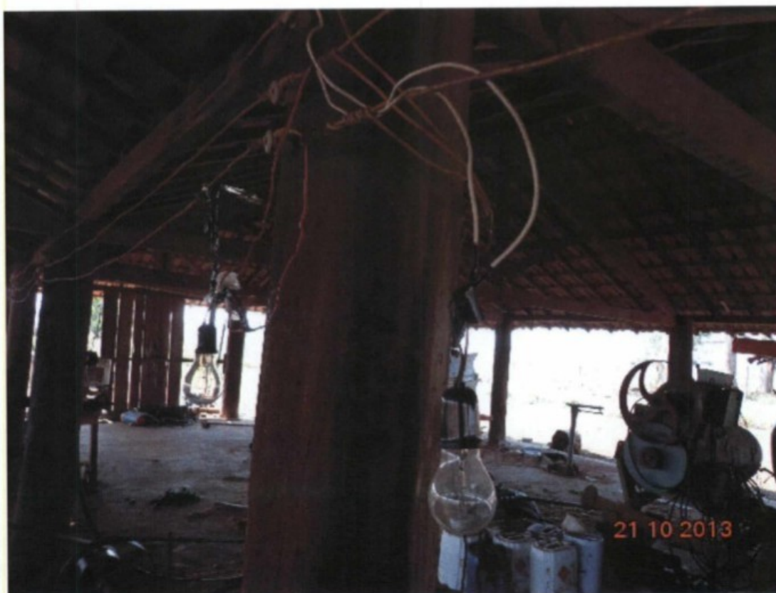
Fiação exposta e montada com inúmeras "gambiarras" gerando risco de choque elétrico
